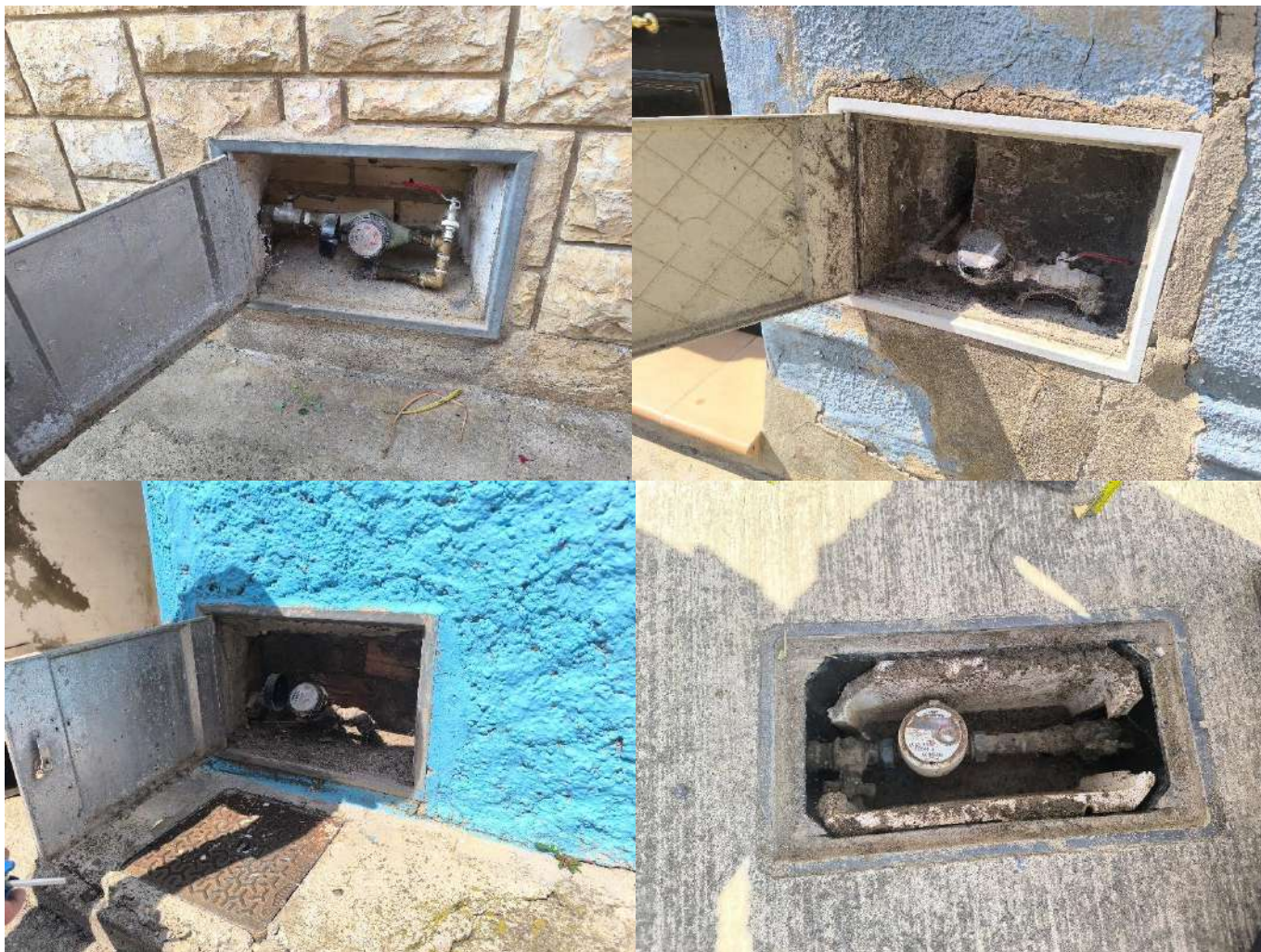
Ilustración 2. Contadores domiciliarios en fachada
