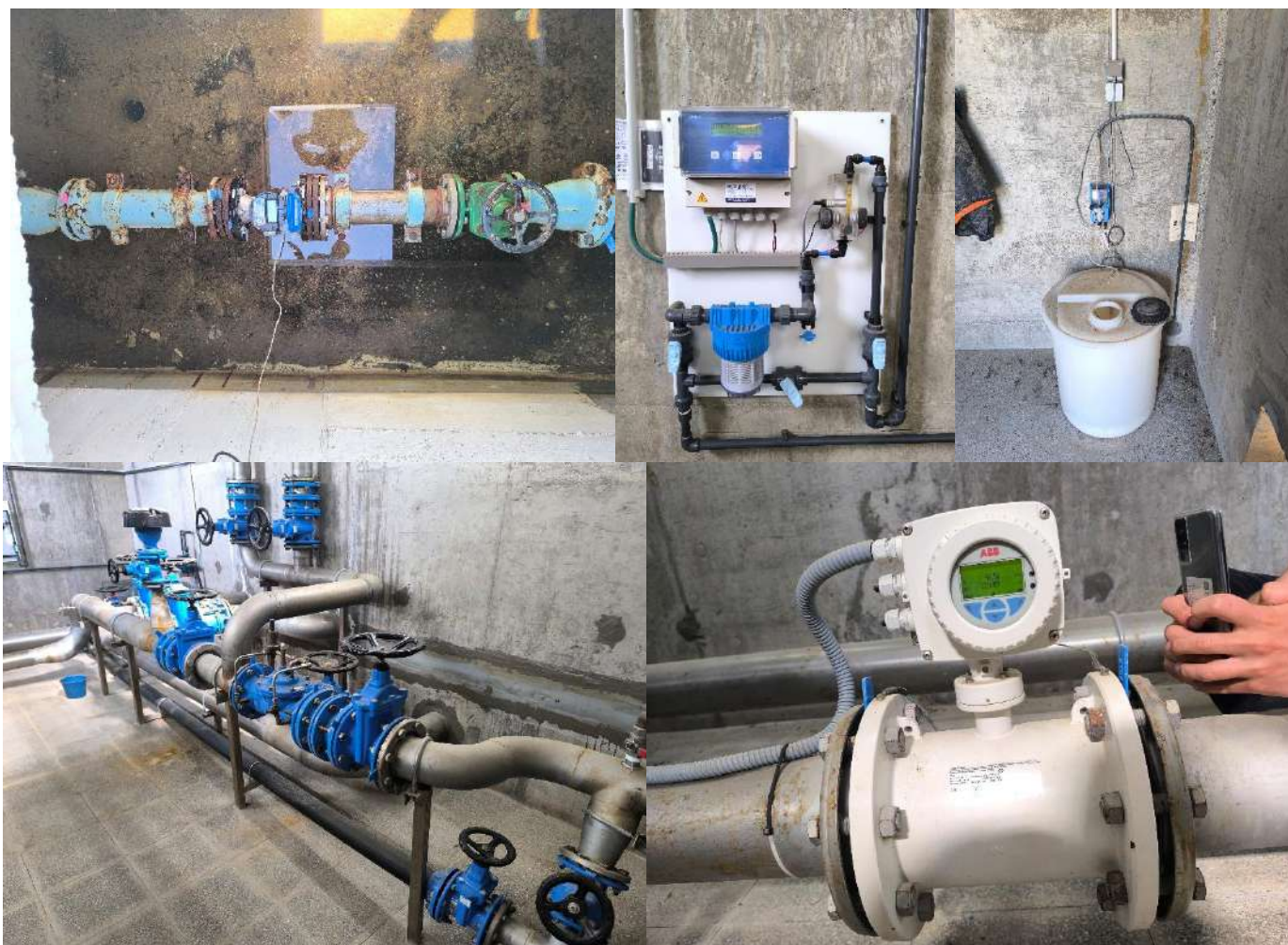
Ilustración 3. Contador de entrada, dosificador de cloro, cámara de llaves y caudalímetro ultrasónico de salida
