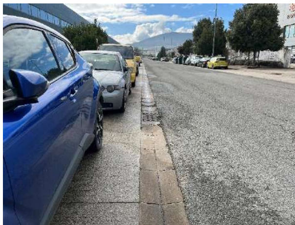
Fotografía 50 Caz deteriorado y marco de sumidero roto
