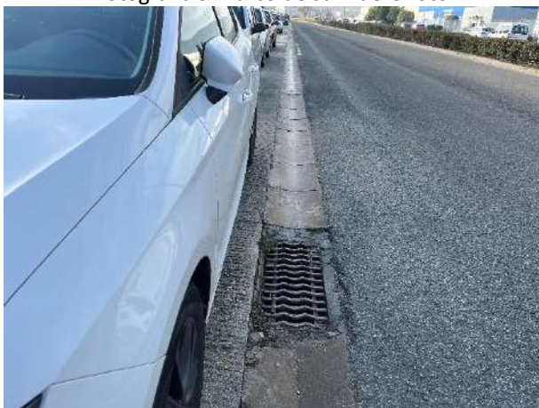
Fotografía 11 Marco de sumidero roto
