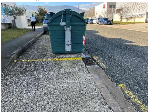
Fotografía 23 Marco de sumidero roto
