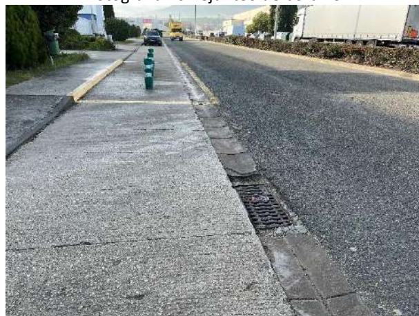
Fotografía 12 Marco de sumidero roto y Caz deteriorado
