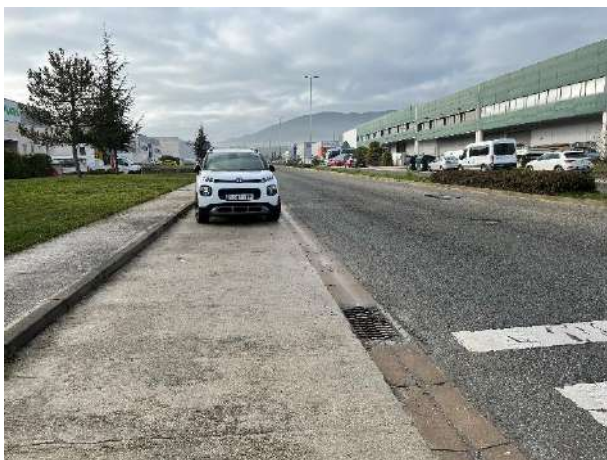
Fotografía 7 Marco de sumidero roto
