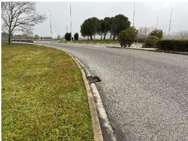
Fotografía 1 Marco de sumidero roto
