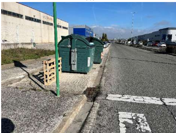
Fotografía 39 Marco de sumidero roto
