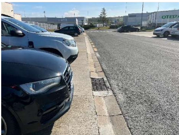
Fotografía 37 Caz deteriorado y marco de sumidero roto
