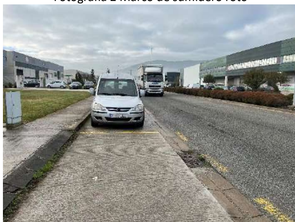
Fotografía 4 Marco de sumidero roto
