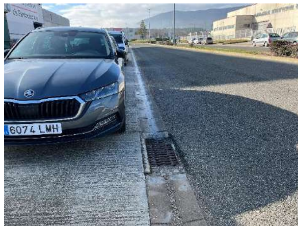
Fotografía 14 Marco de sumidero roto
