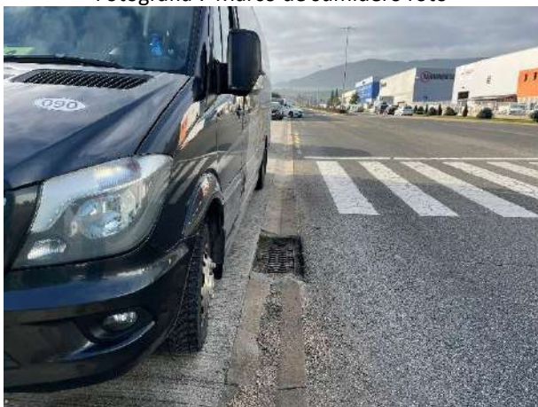
Fotografía 9 Marco de sumidero roto
