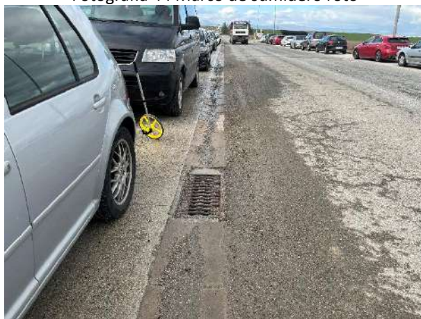
Fotografía 46 Marco de sumidero roto
