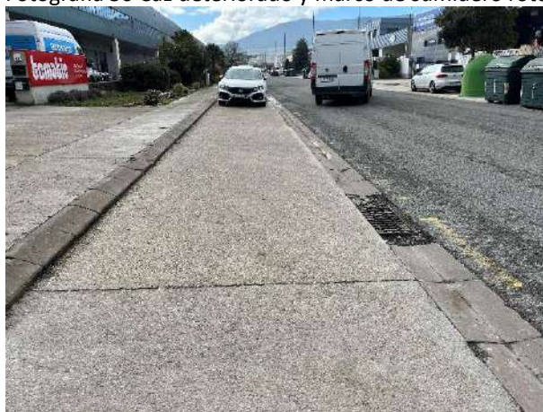
Fotografía 52 Caz deteriorado y marco de sumidero roto
