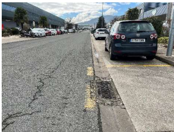
Fotografía 54 Marco de sumidero roto
