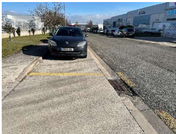
Fotografía 32 Marco de sumidero roto
