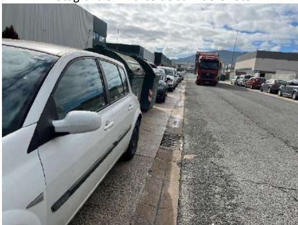
Fotografía 59 Marco de sumidero roto
