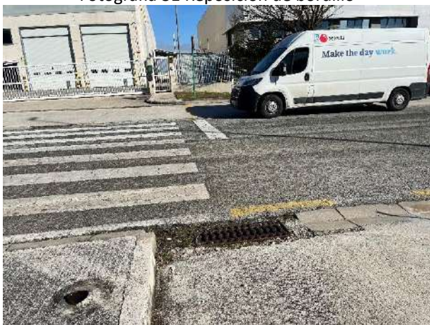
Fotografía 33 Marco de sumidero roto
