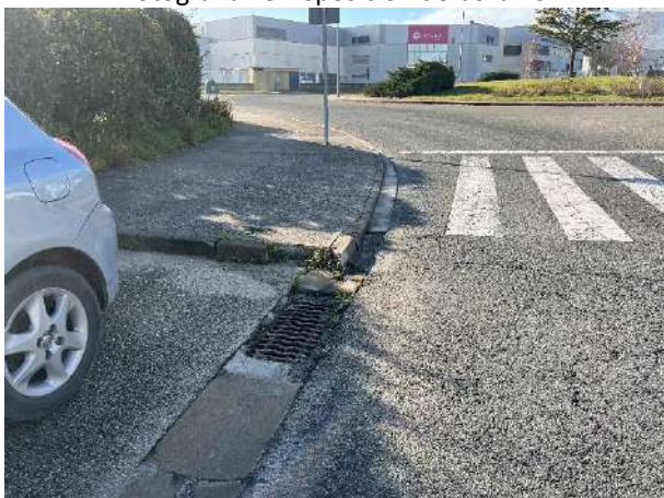
Fotografía 17 Marco de sumidero roto y reposición de bordillo
