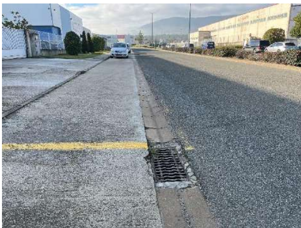
Fotografía 13 Marco de sumidero roto
