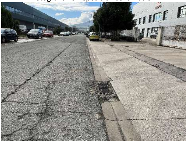
Fotografía 51 Caz deteriorado y marco de sumidero roto
