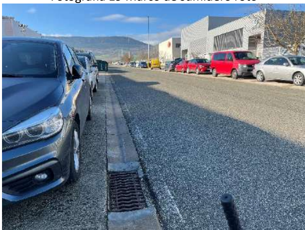
Fotografía 21 Marco de sumidero roto
