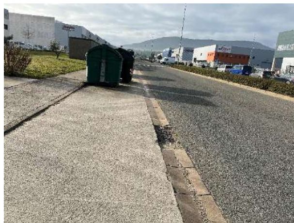
Fotografía 8 Marco de sumidero roto
