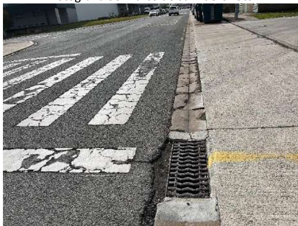
Fotografía 60 Caz deteriorado y marco de sumidero roto
