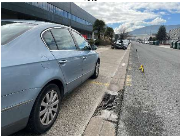
Fotografía 53 Marco de sumidero roto
