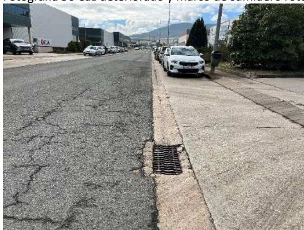
Fotografía 58 Marco de sumidero roto
