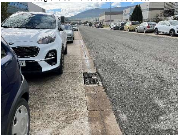
Fotografía 57 Marco de sumidero roto
