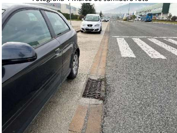
Fotografía 6 Marco de sumidero roto
