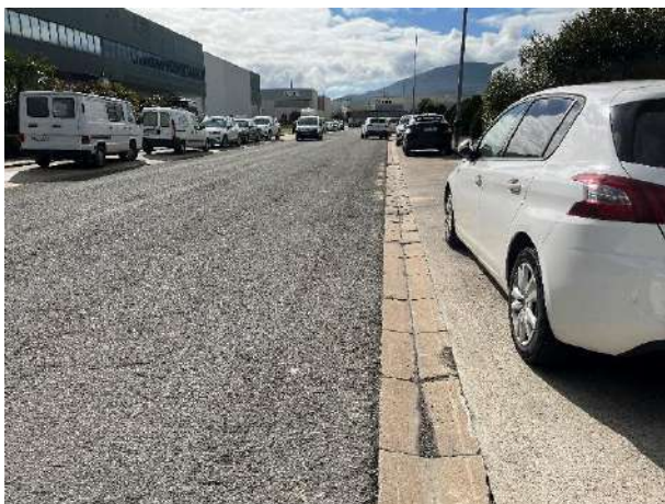
Fotografía 61 Caz deteriorado y marco de sumidero roto
