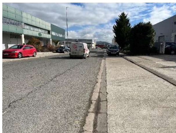
Fotografía 64 Caz deteriorado y marco de sumidero roto
