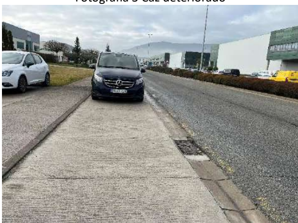
Fotografía 5 Marco de sumidero roto
