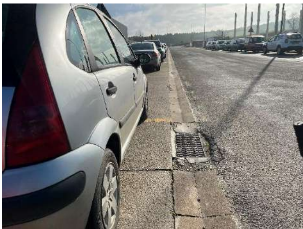
Fotografía 19 Marco de sumidero roto
