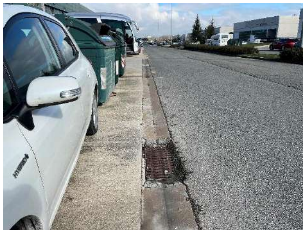
Fotografía 44 Marco de sumidero roto
