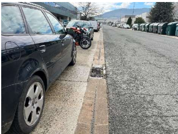
Fotografía 55 Marco de sumidero roto
