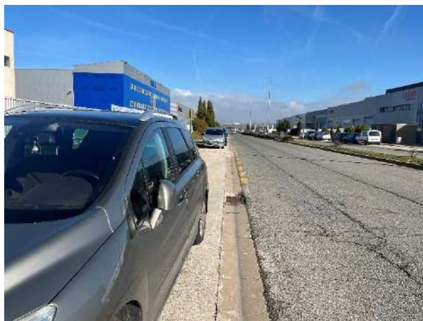
Fotografía 40 Marco de sumidero roto
