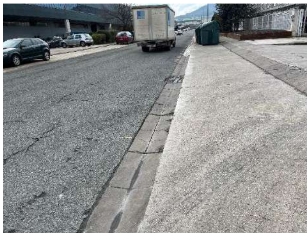
Fotografía 56 Caz deteriorado y marco de sumidero roto
