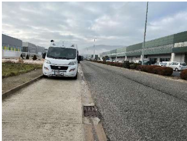
Fotografía 2 Marco de sumidero roto
