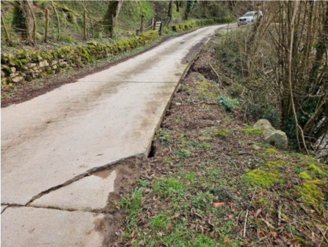
Fotografía2 del terraplén derrumbado en el camino y conducción general de agua de Amaiur Pavimento de hormigón sin apoyo en 1 m.
