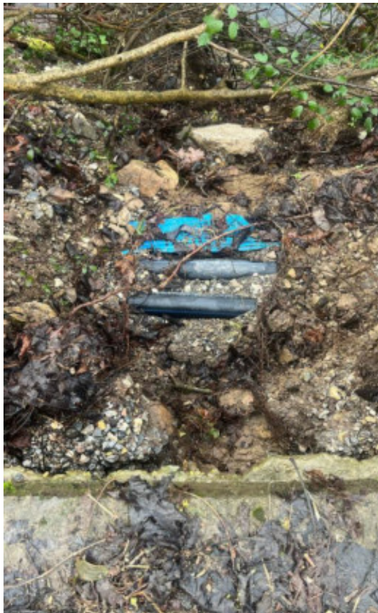
Fotografía3 del terraplén derrumbado en el camino y conducción general de agua de Amaiur
