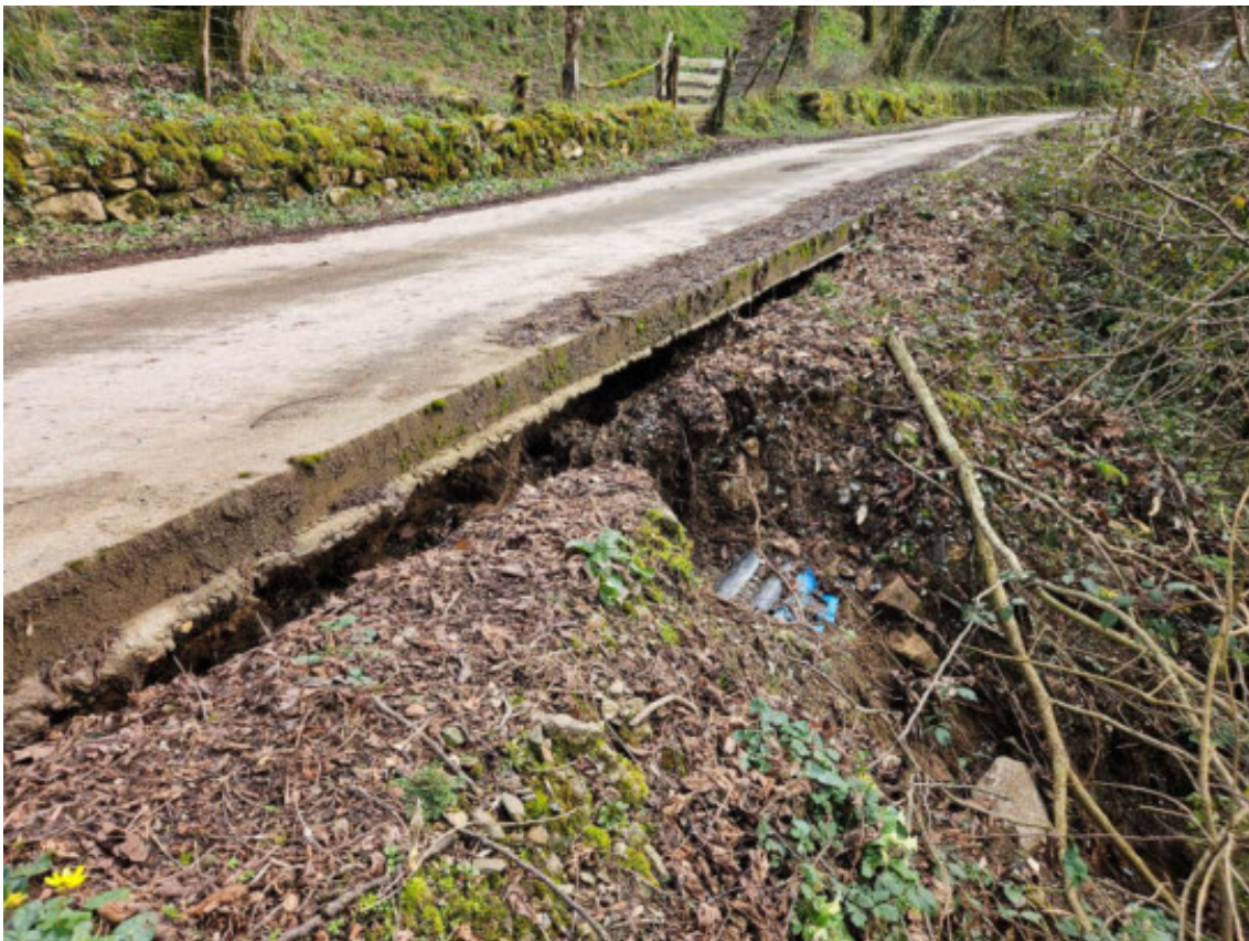
Fotografía1 del terraplén derrumbado en el camino y conducción general de agua de Amaiur Pavimento de hormigón sin apoyo en 1 m.
