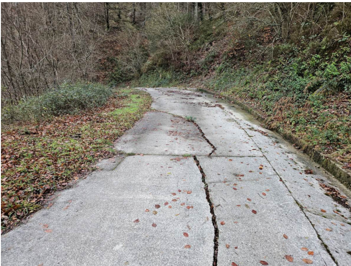
Fotografía del estado actual del camino Beltxenea con grietas de más de 10 cm de anchura y escalones en el pavimento.
