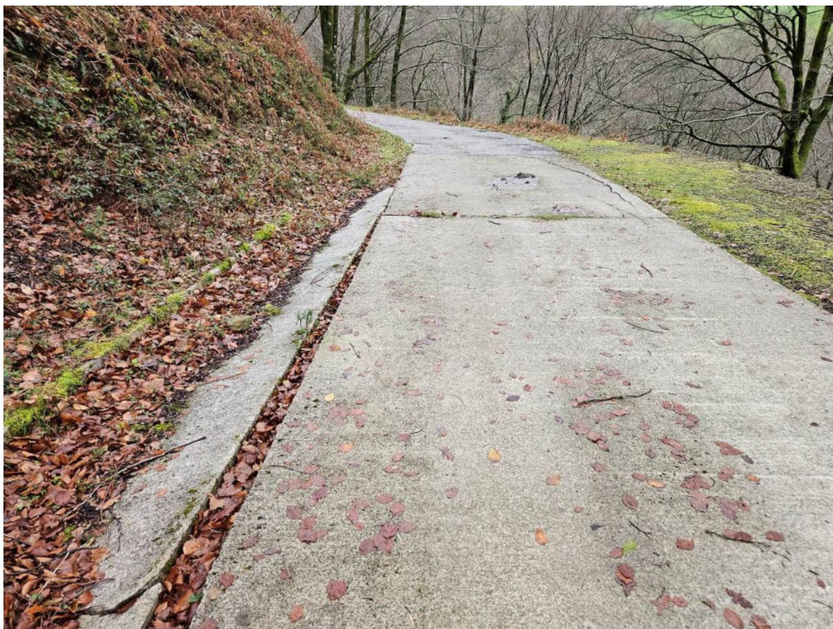
Fotografía del estado actual del camino Beltxenea con grietas de más de 10 cm de anchura entre la cuneta y el firme
