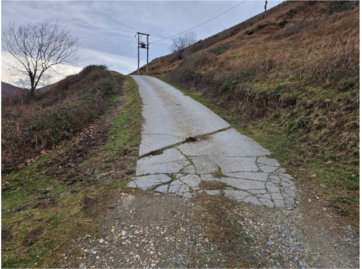
Fotografía del estado actual del camino Komaineko Borda (Parte final hacia la carretera de Gorramendi) con apenas zahorras artificiales y sin finos (Gravas sueltas)
