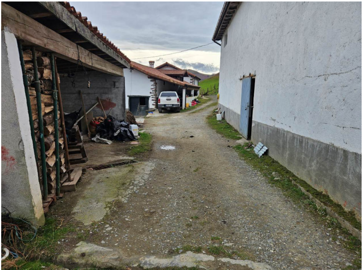
Fotografía del estado actual del camino Komaineko Borda (Junto a vivienda) con apenas zahorras artificiales y sin finos (Gravas sueltas)
