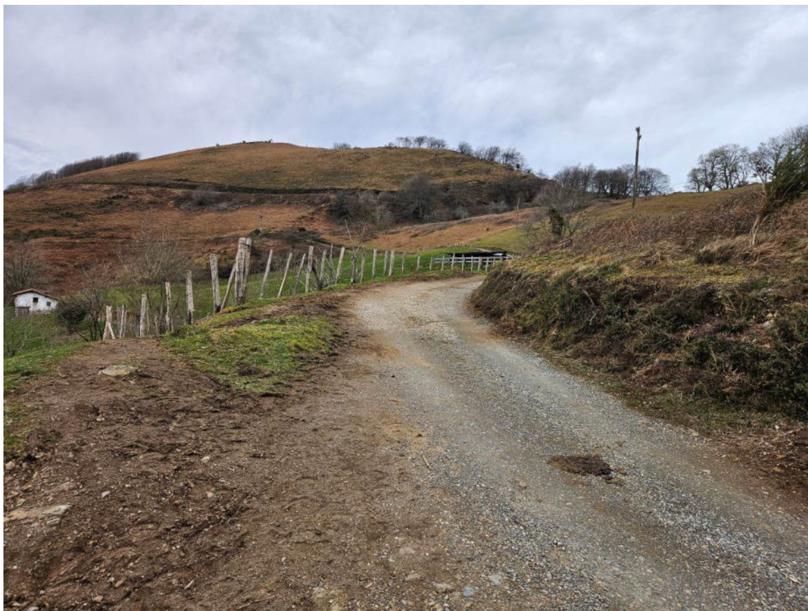
Fotografía del estado actual del camino Komaineko Borda (Parte central) con apenas zahorras artificiales y sin finos (Gravas sueltas)
