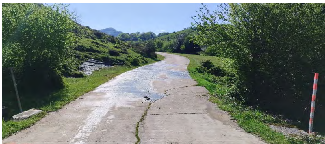
Imagen que muestra cómo las escorrentías invaden la plataforma.
