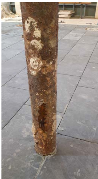
Estado de los pilares una vez derribada la isleta en actuación de 2019
