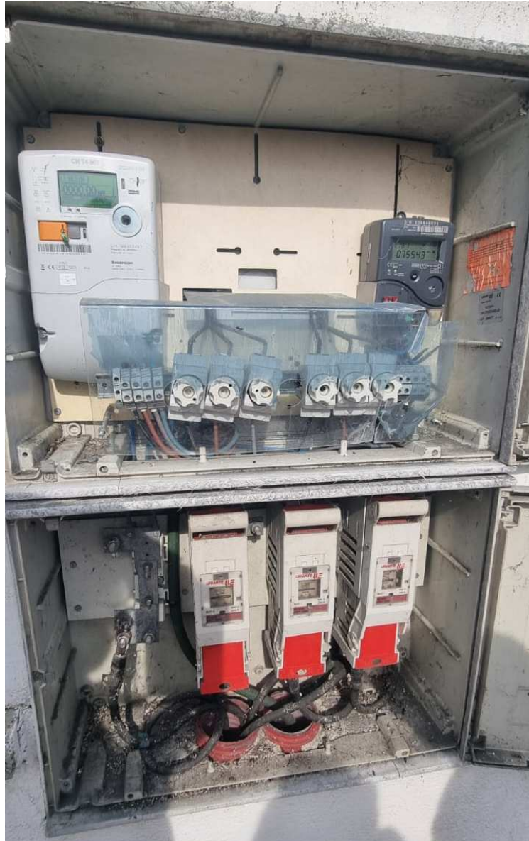
Contador actual del suministro.
