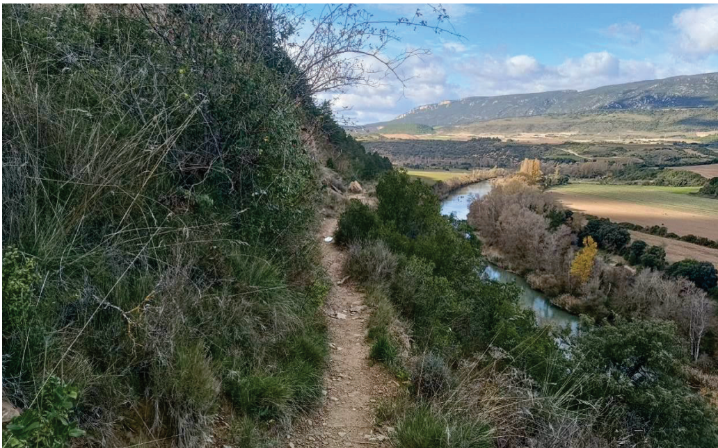
Foto 2: Zona del camino Urdina a ensanchar y eliminar derrumbes
