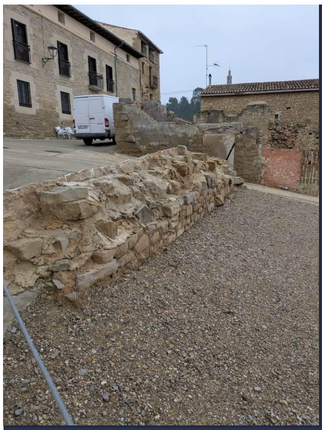
FOTOGRAFÍA 4: ESTADO INICIAL DEL MURO DE SEPARACIÓN SUPERIOR
