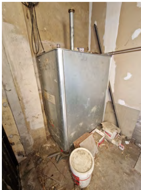
Depósito de gasóleo
