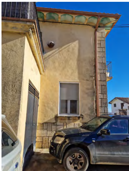
Humedades en las fachadas
