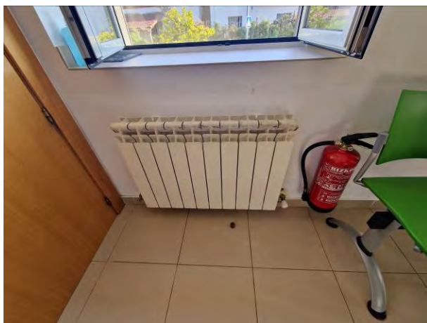
Radiador en Sala de espera
