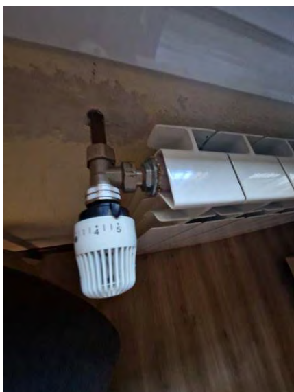
Condensaciones en paredes
