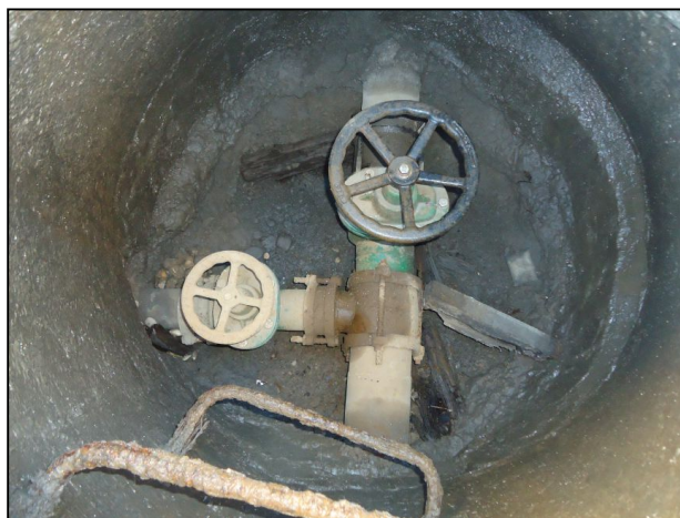
Conexión abastecimiento Raimundo Lanás con Hijuelo:
