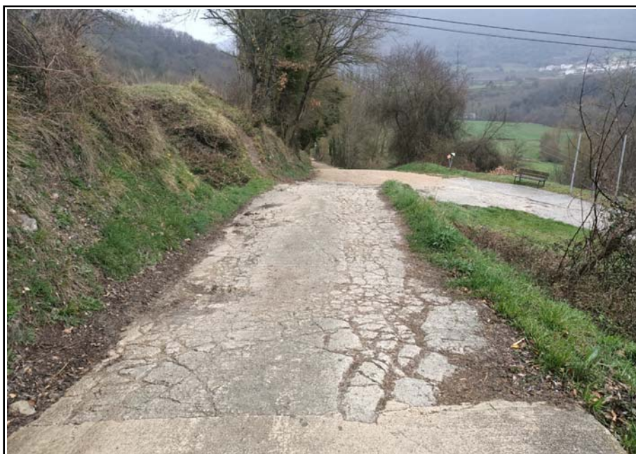
Imagen 6: Zona de la curva del camino de la Central que hay que reparar donde se observa el deterioro del pavimento.
