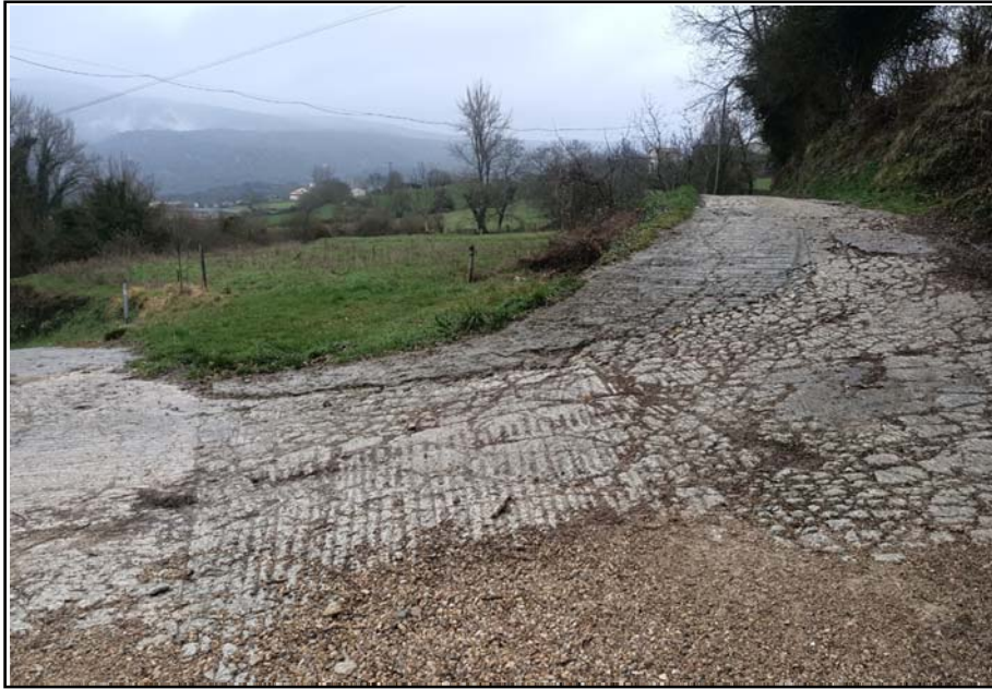
Imagen 7: Imagen desde la zona del banco que se aprecia en la imagen anterior donde se observa el estado del pavimento.
