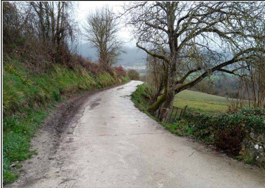
Imagen 1: Vista desde el extremo este del tramo afectado, en las proximidades del lavadero. El tramo a reparar comenzaría en la zona de la puerta metálica que se observa a la derecha. Se observa el pavimento de hormigón agrietado y huellas en el talud por el desvío del tráfico que evita pasar por esa zona. También se aprecia el estado de los árboles del talud derecho (lado terraplén) en el que uno de ellos está muy inclinado y podría caer dañando el camino.
