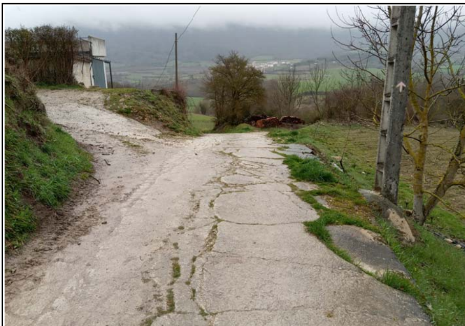
Imagen 2: Zona final del tramo a reparar a la altura del poste eléctrico donde se aprecia el estado deteriorado del pavimento.
