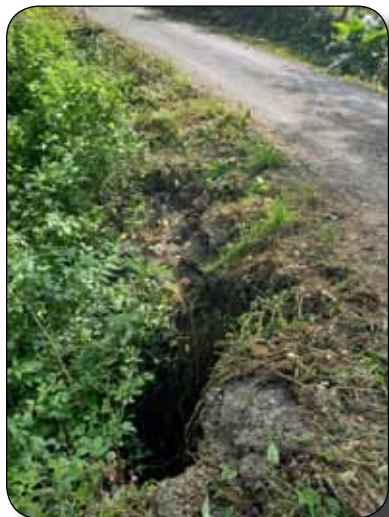
Suspelttiki 2. Agujero generado en el terraplén
