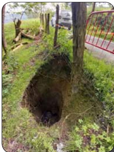
Suspelttiki 1. Agujero generado en el terraplén
