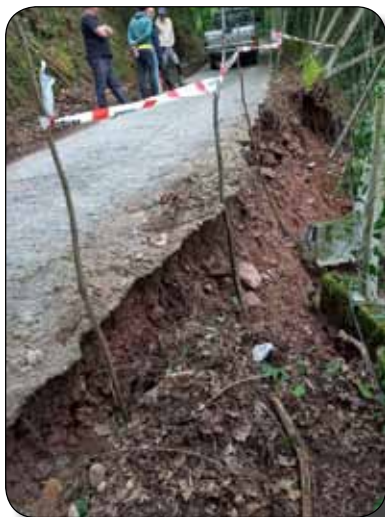
Peñaborda. Colapso en terraplén
