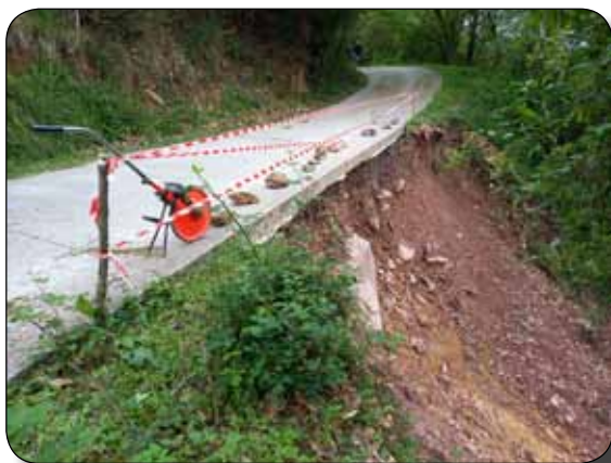
Larratxen Borda. Derrame del terraplén
