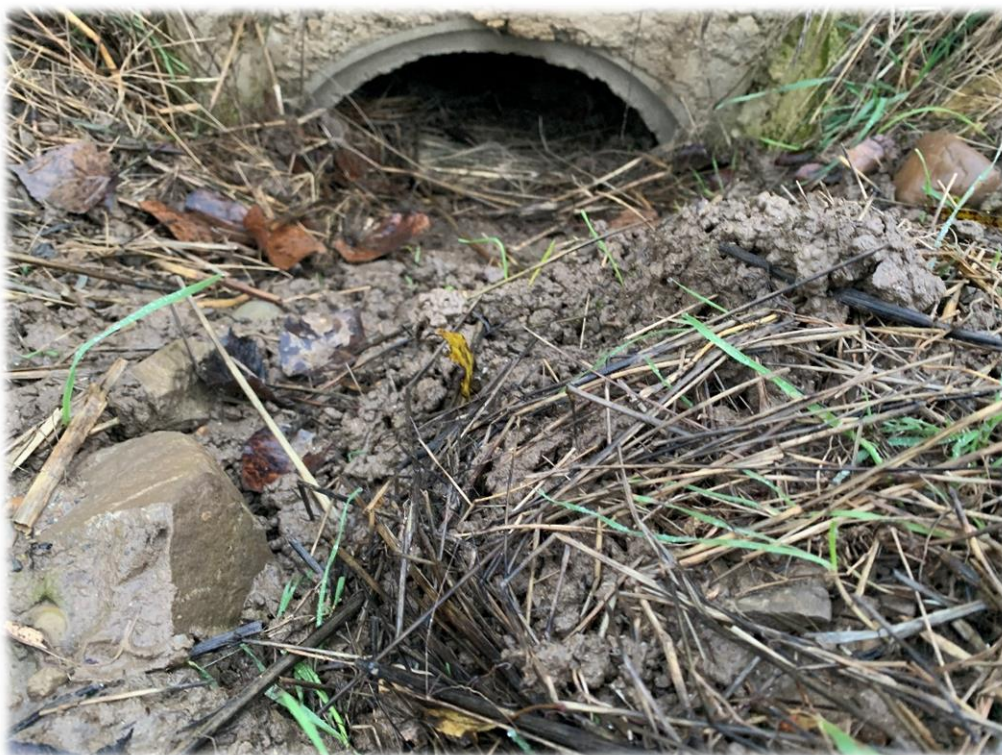
Fotografía 5: Caño obturado a limpiar.
