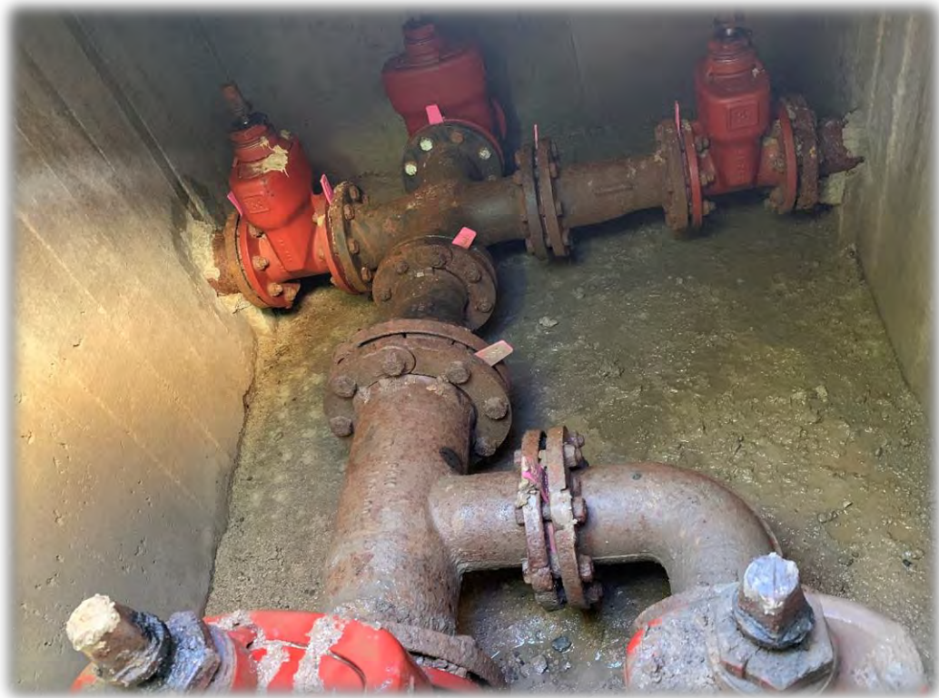
Fotografía 5: Arqueta de la Red de Distribución existente en la Carretera de Lerín.
