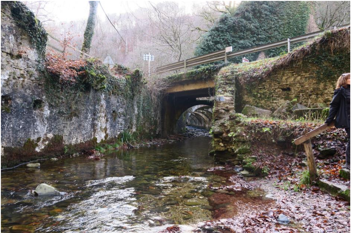
Vista del cauce del río desde la zona donde se ha arruinado el muro que lo canaliza con el puente construido para el paso de la carretera a comienzos del siglo XX y, al fondo, los arcos del interior de la Carbonera Mayor.
