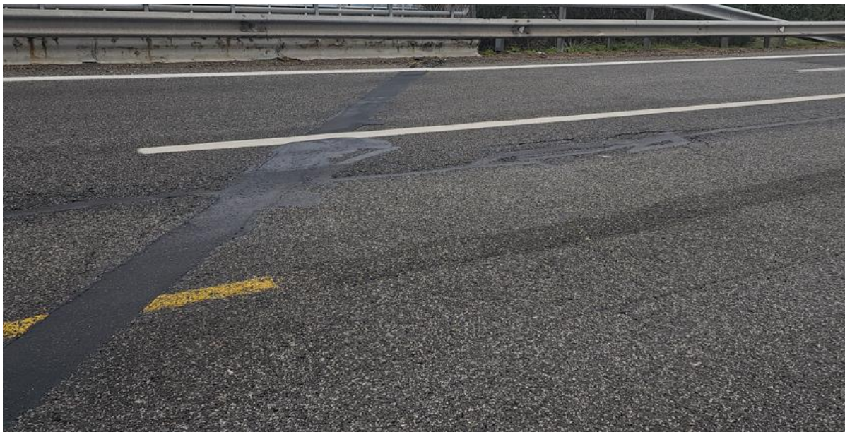
Aspecto del sabeo localizado en el trasdós del pk 50+400 sur.
