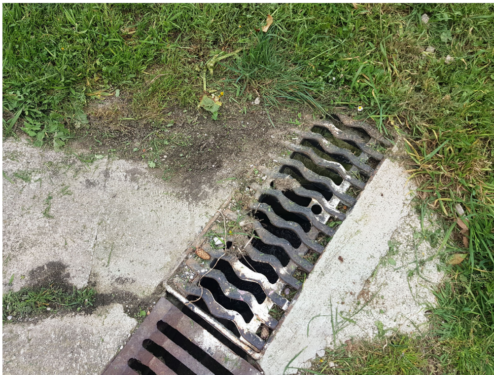
Imagen 03. Extremo norte del camino. Canaleta existente.
