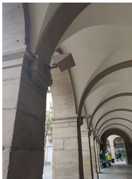
DETALLE PROYECTORES BAJO PÓRTICO
