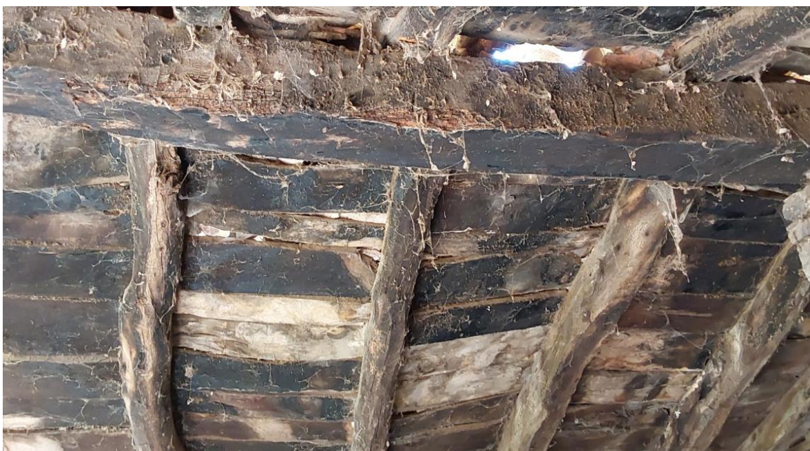
Deterioro en la estructura
