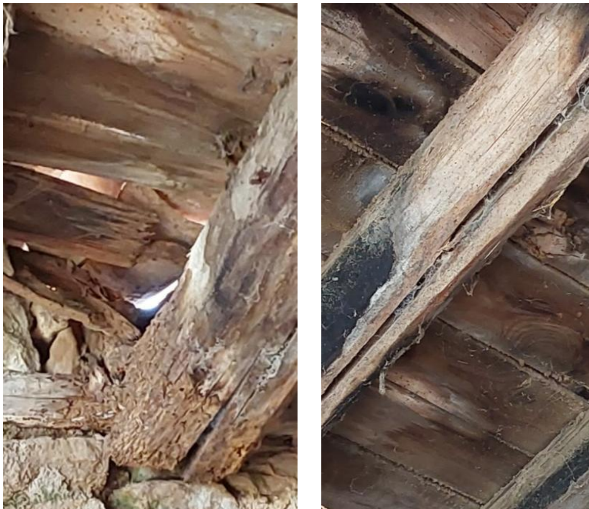
Defectos en estructura
