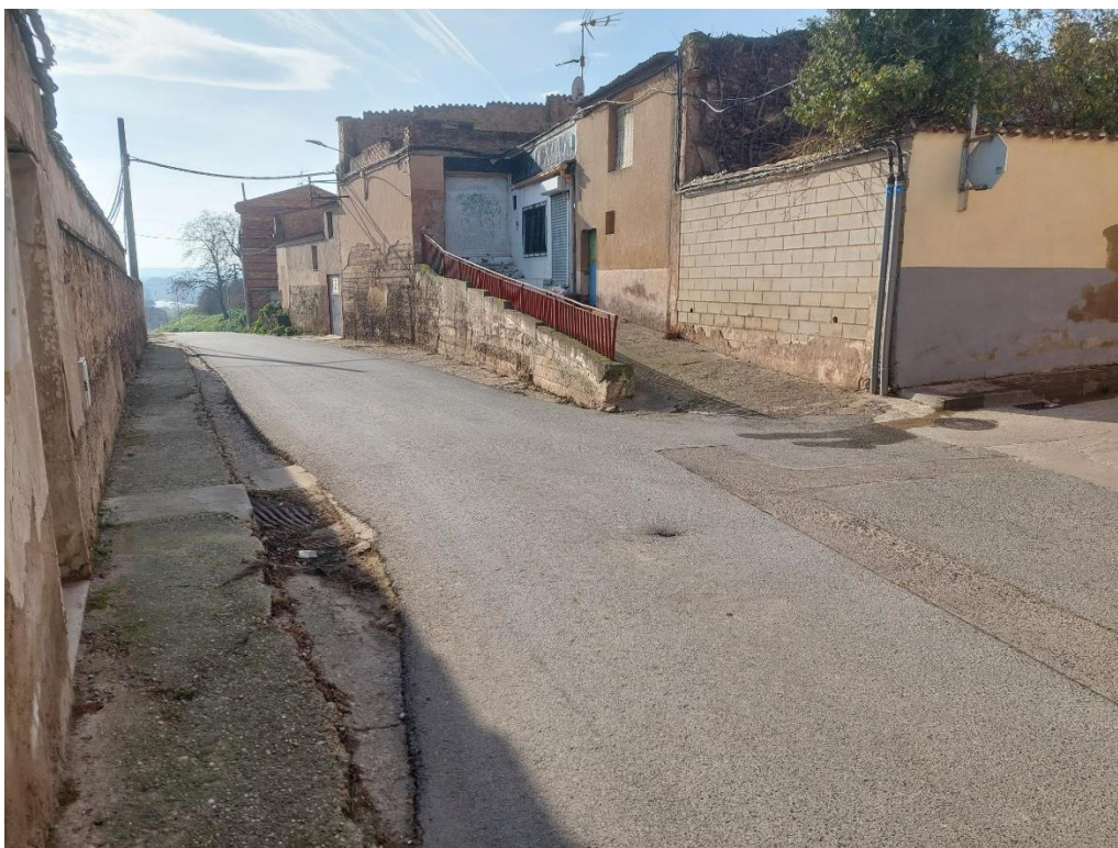
Cruce c/Barranco con c/Miguel Indurain, zona afectada por el mayor estrechamiento.
