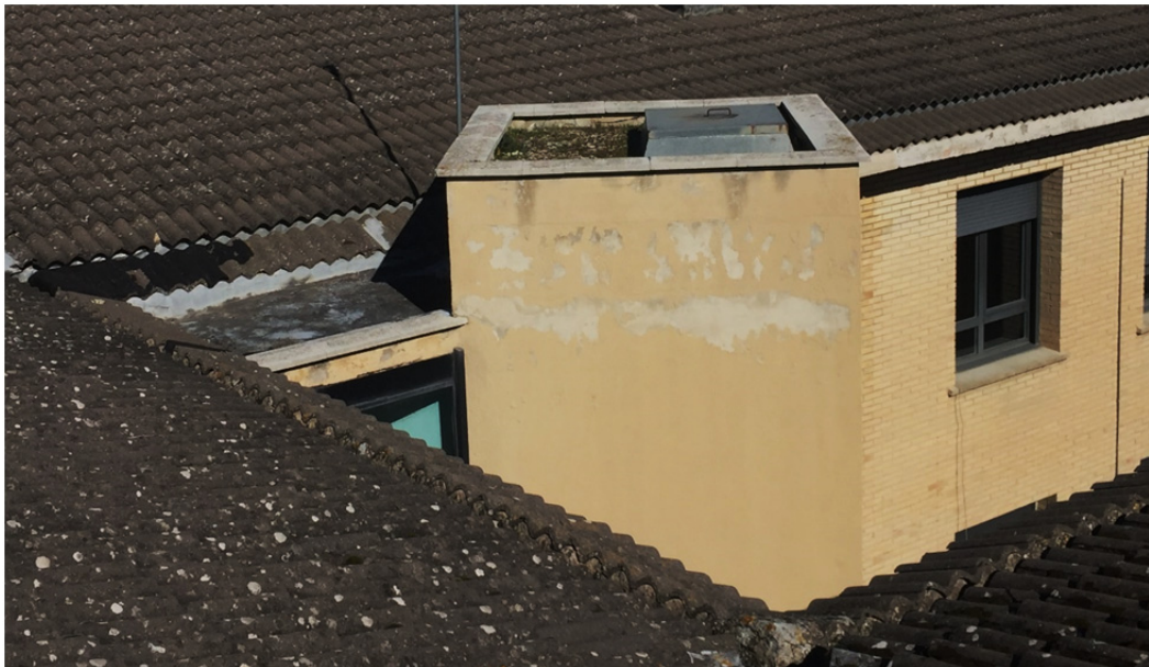
CAJA DE ASCENSOR
