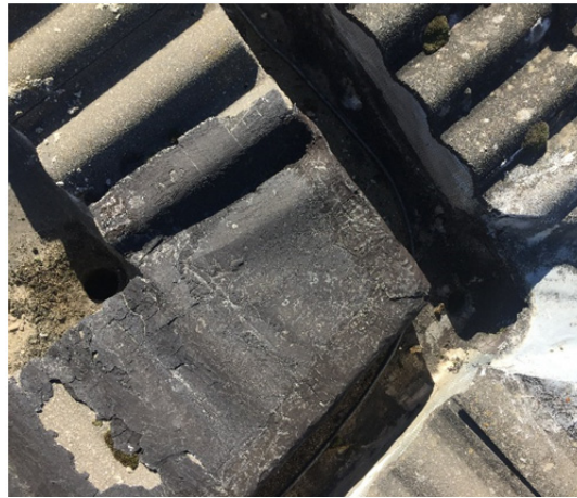
CANALÓN ACTUAL Y ROTURA TELAS
