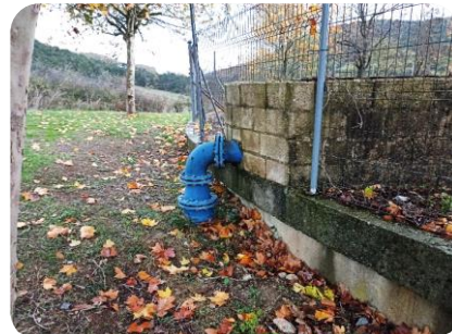
F42 Pk4+800. Conexión entrada a depósito.
