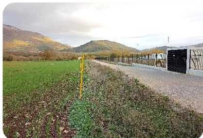
F13 Cruce gas camino Harivenasa Pk1+205
