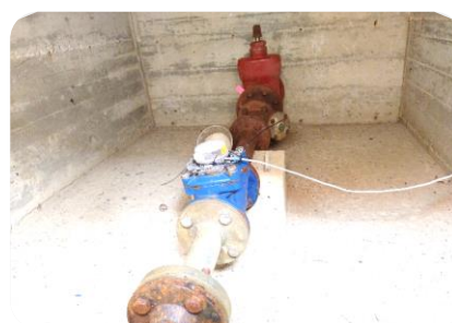
F7 Interior registro. Contador en ramal FN100.
