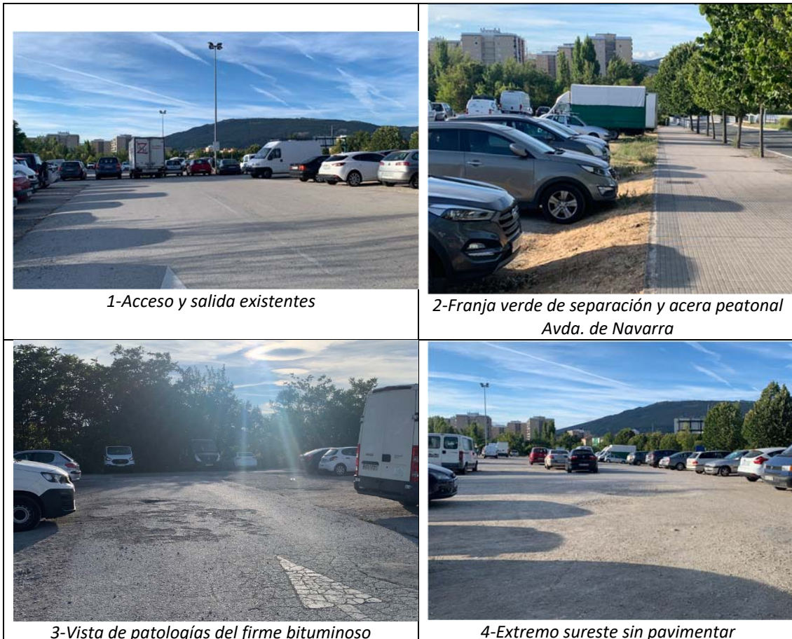
Figura nº 2: fotografías del estado actual del aparcamiento de San Juan
