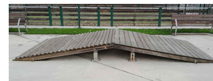
3 ELEMENTO A MODIFICAR SU SITUACIÓN DENTRO DEL PARQUE
