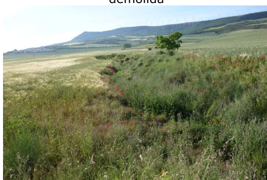
Regata Zariquiegui a cruzar en zanja. Se observa la degradación de la misma
