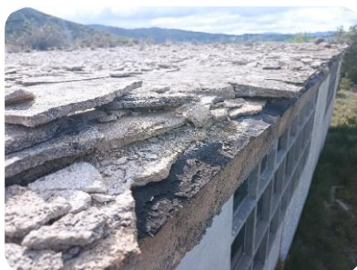
F9: Pérdida lámina asf y mortero cubierta
