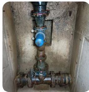
F2.2: Arq. Izda. Derivación con regulación presión a Dep PI
