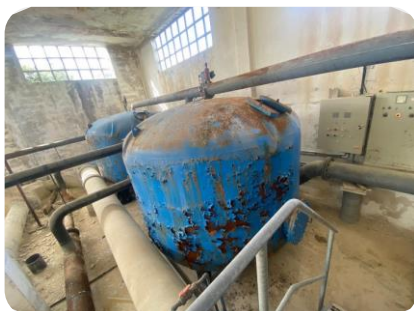
F14: Antiguos filtros a. bruta bombeo
