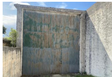
F6: Puerta acceso cámara llaves
