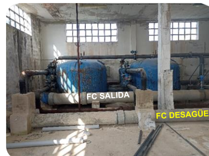
F19: Vista general filtros/conducciones
