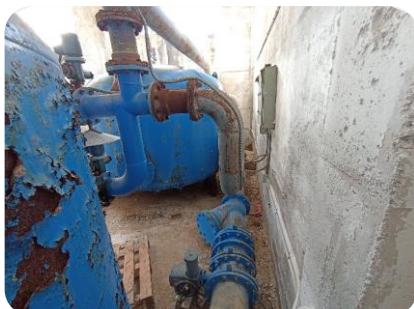
F17: Entrada a. tratada Mancomunidad
