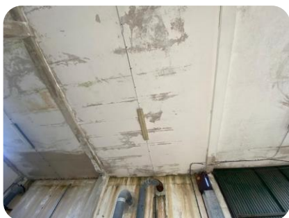
F22: Humedad unión c. llaves-vaso
