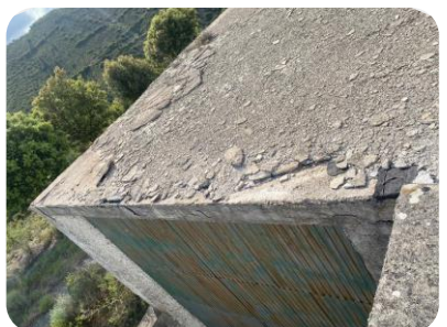
F7: Pérdida lámina asf y mortero
