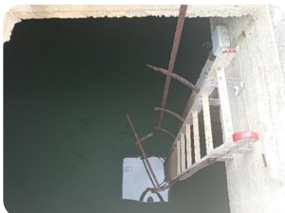
F7: Escalera y guardacuerpo (oxidado)
