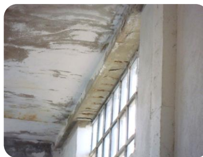
F24: Pérdida hor. vigas ventana
