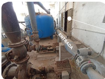
F15: Entrada a. tratada Mancomunidad
