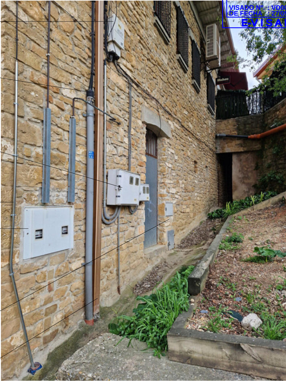
FOTOGRAFIA DE INSTALACIONES A REUBICAR
