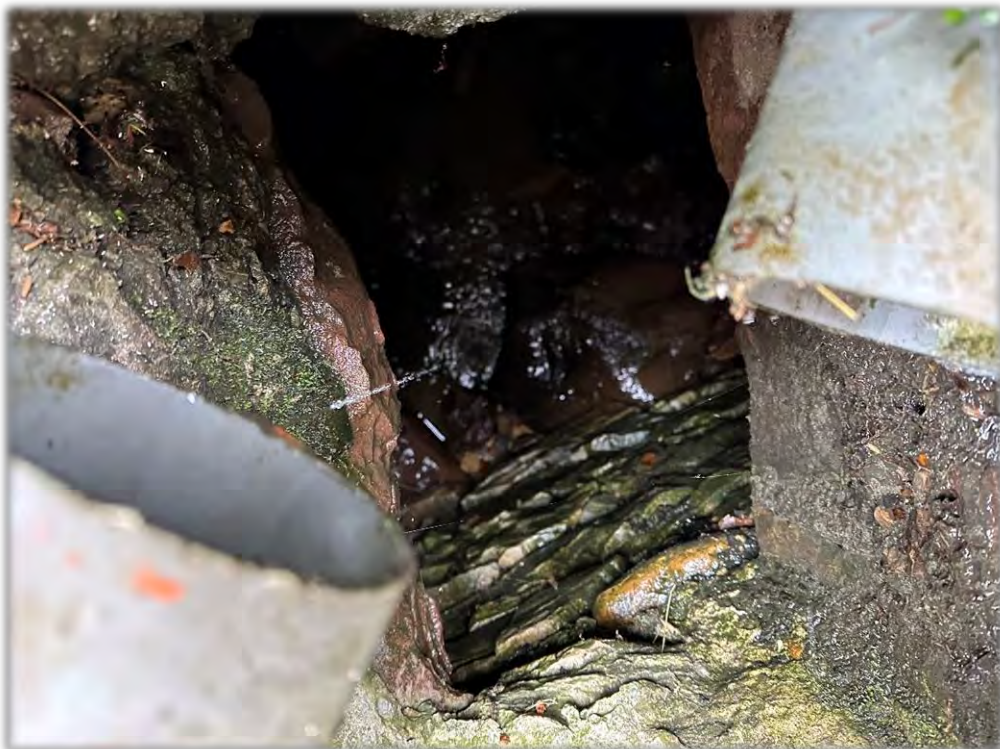
Fotografía 6: Vista del canal desde sumidero en cruce de Gernikako Arbola Zeharbidea con San Esteban karrika.
