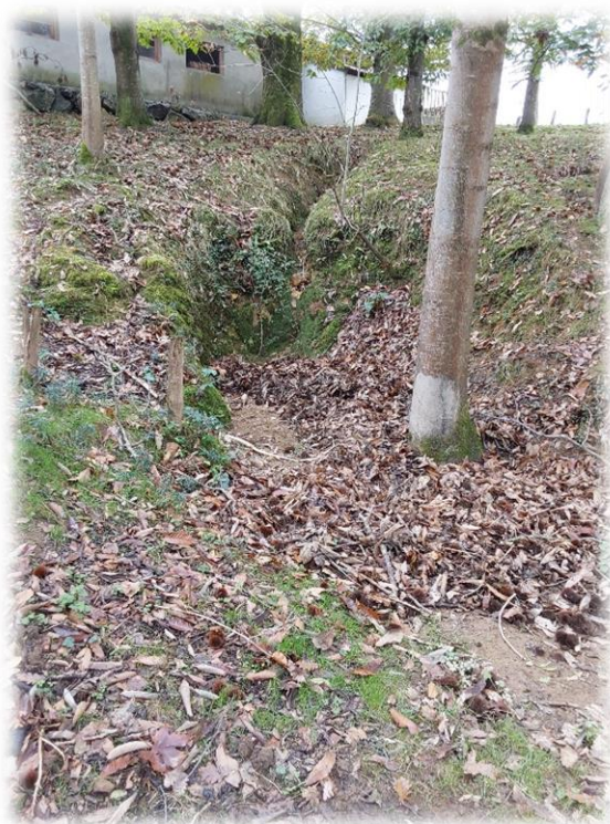
Fotografía 16 Entrada a obra de drenaje transversal anegada por las tierras que arrastró la regata.
