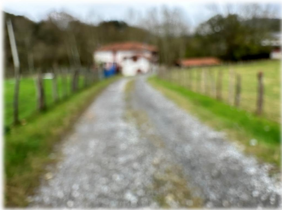
Fotografía 14: Roderas creadas por la escorrentía superficial, y pérdida de la capa rodadura.
