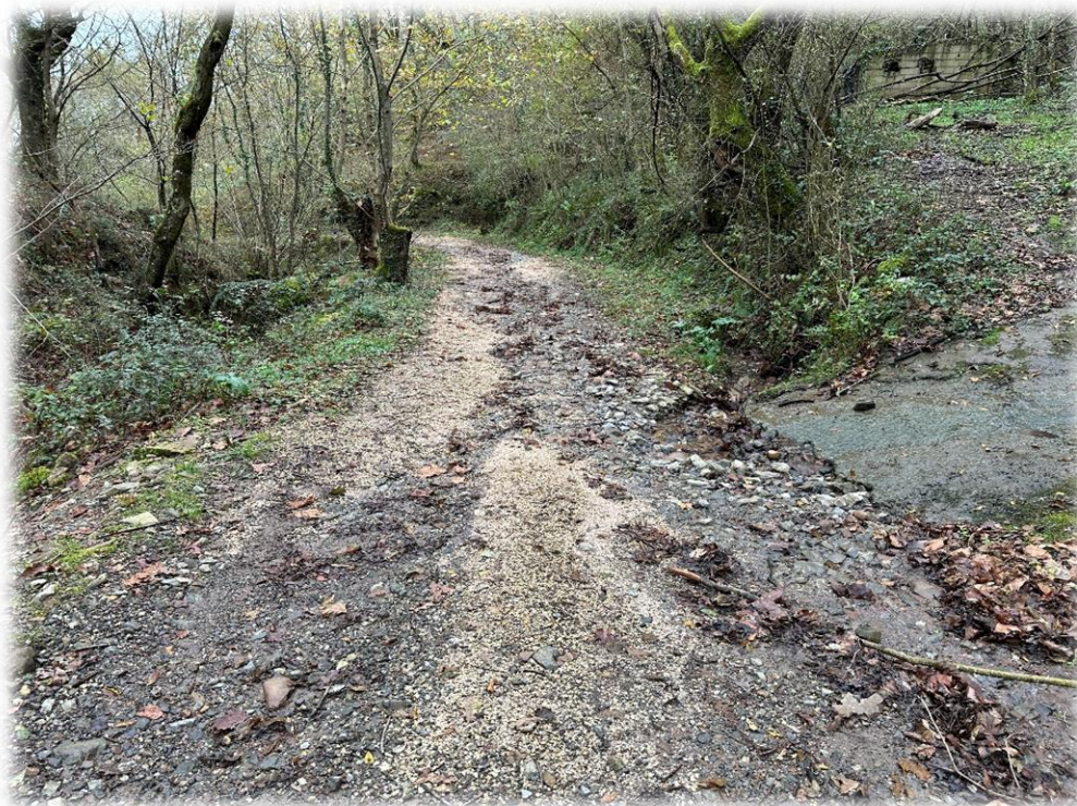
Fotografía 13: Roderas creadas por la escorrentía superficial, y pérdida de la capa rodadura.
