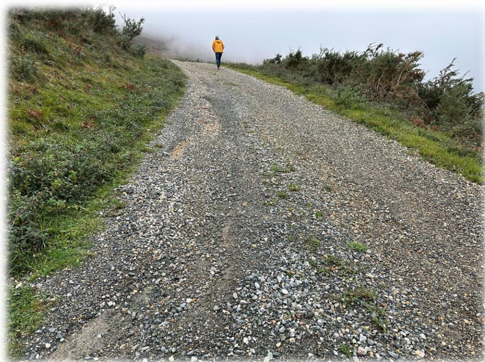
Fotografía 9: Roderas creadas por la escorrentía superficial, y pérdida de la capa rodadura
