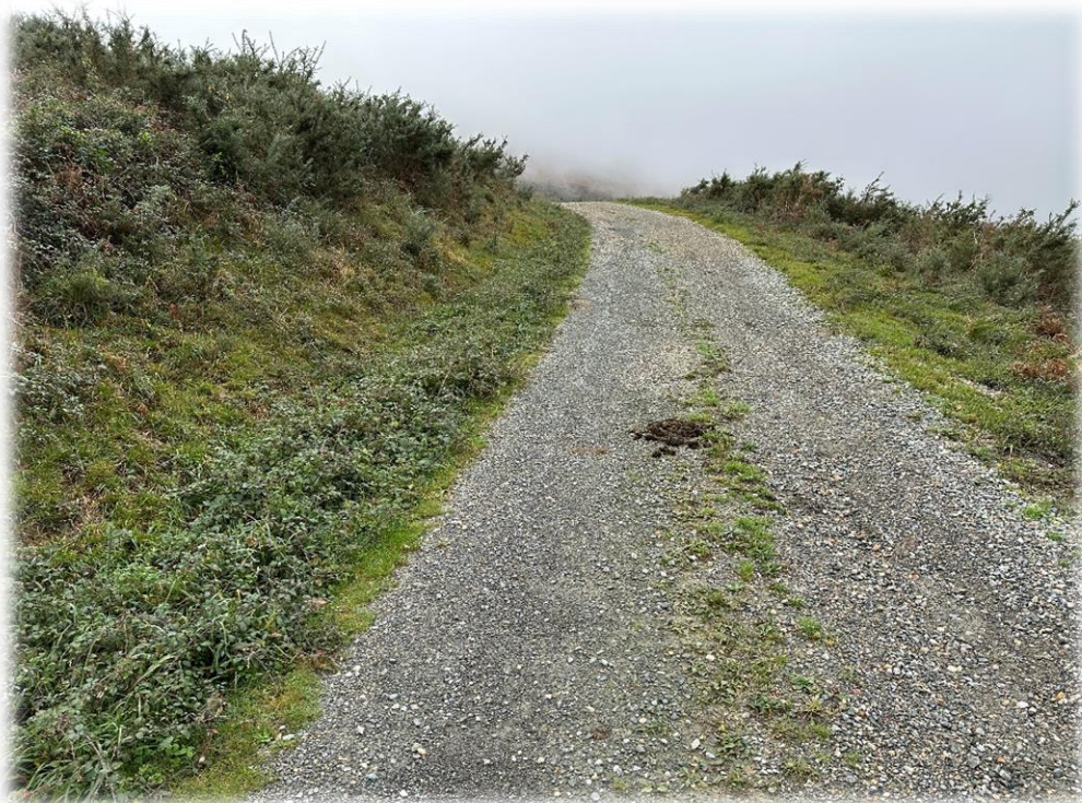
Fotografía 11: Roderas creadas por la escorrentía superficial, y pérdida de la capa rodadura.
