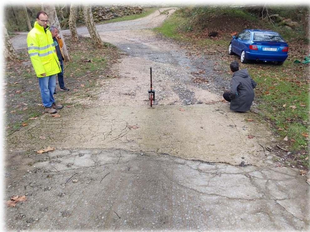
Fotografía 17: Roderas creadas por la escorrentía superficial, y pérdida de la capa rodadura.
