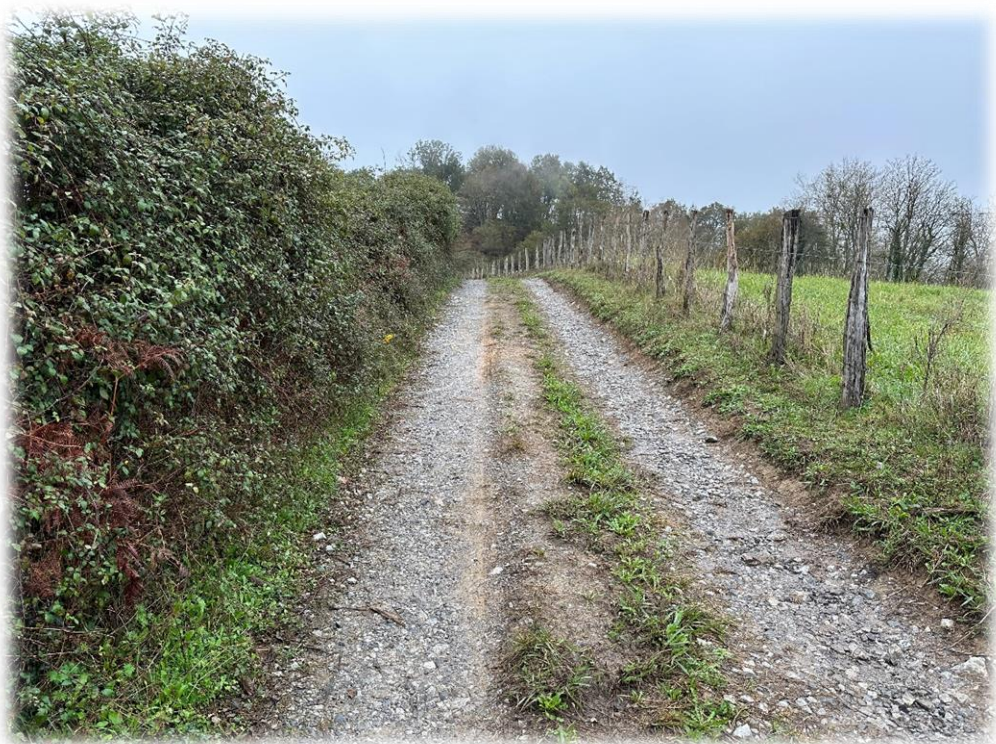
Fotografía 2: Roderas creadas por la escorrentía superficial.
