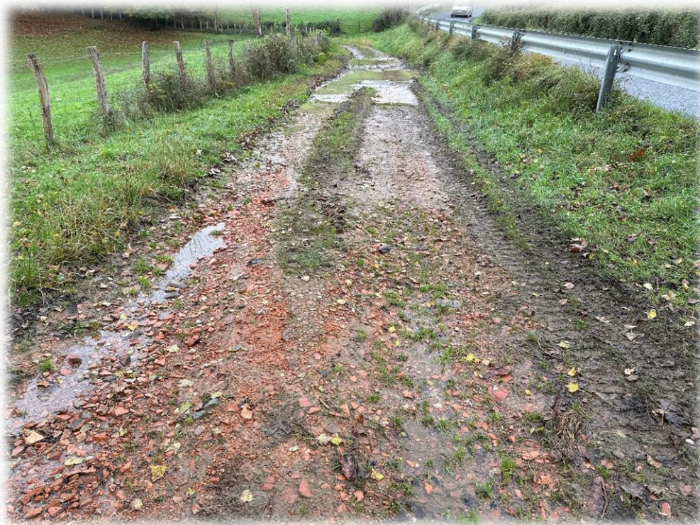
Fotografía 5: Roderas creadas por la escorrentía superficial y pérdida del material de rodadura.
