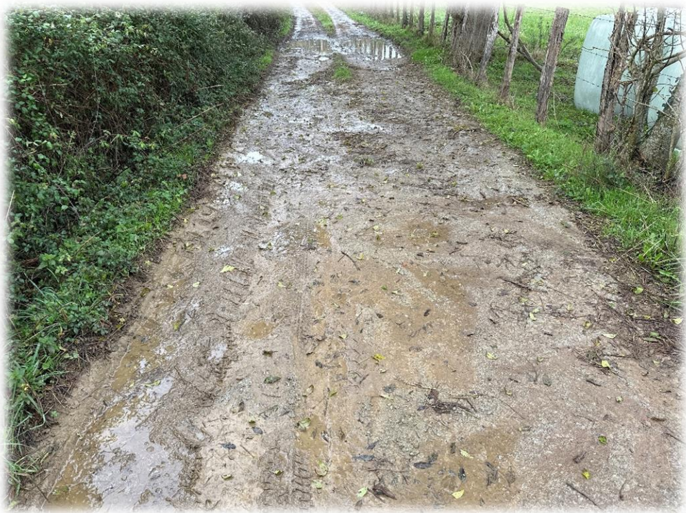
Fotografía 1: Roderas creadas por la escorrentía superficial.
