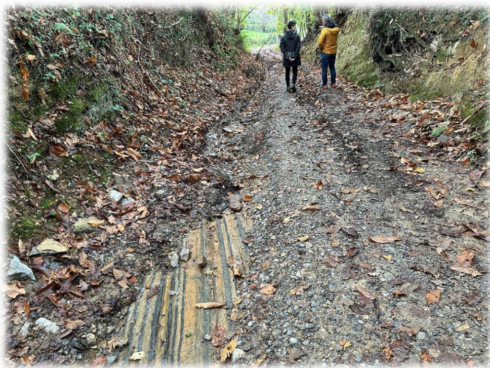
Fotografía 8: Roderas creadas por la escorrentía superficial y pérdida del material de rodadura.
