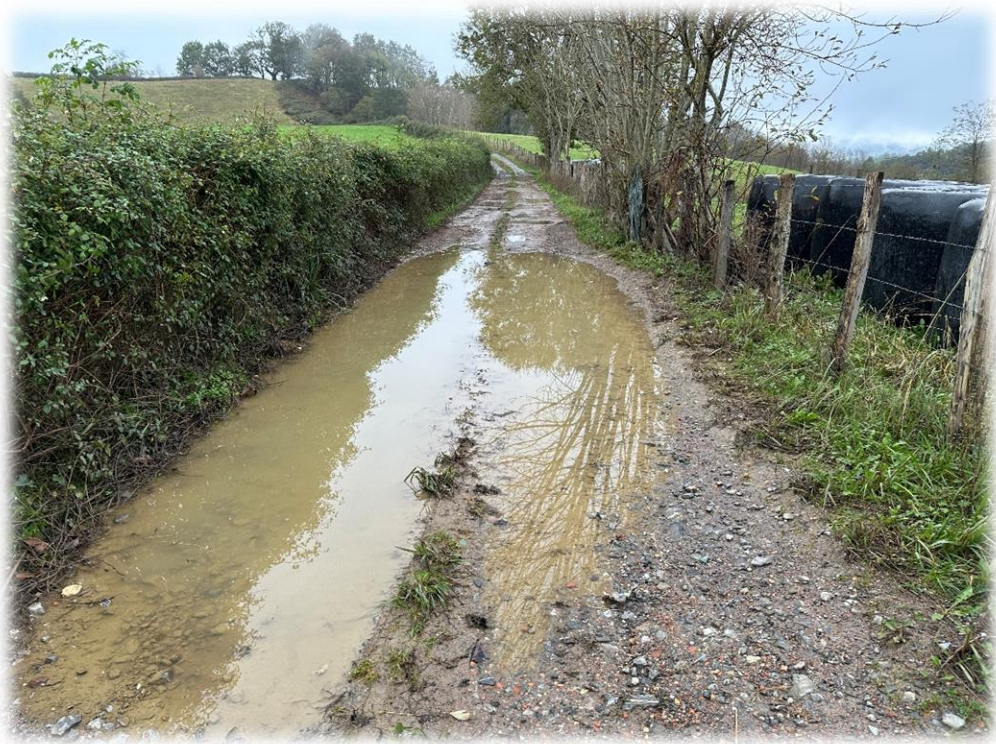
Fotografía 4: Roderas creadas por la escorrentía superficial.
