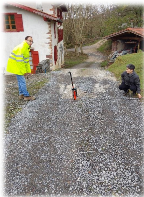
Fotografía 15: Roderas creadas por la escorrentía superficial, y pérdida de la capa rodadura.
