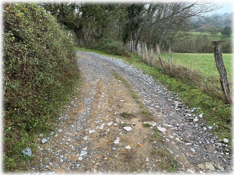
Fotografía 3: Roderas creadas por la escorrentía superficial.
