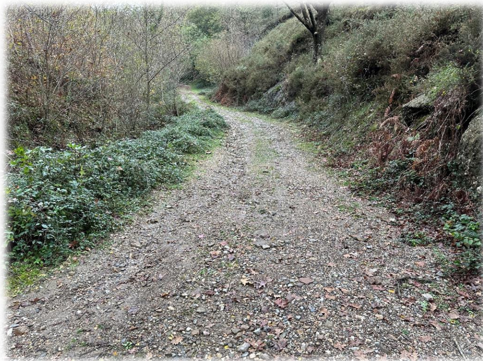
Fotografía 12: Roderas creadas por la escorrentía superficial, y pérdida de la capa rodadura.
