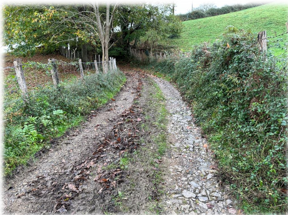
Fotografía 6: Roderas creadas por la escorrentía superficial y pérdida del material de rodadura.
