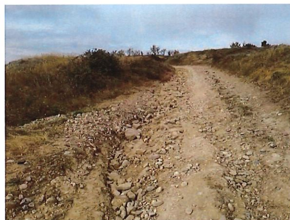
CAMINO 34 – Erosión, rodadas profundas, materiales grandes sueltos.
