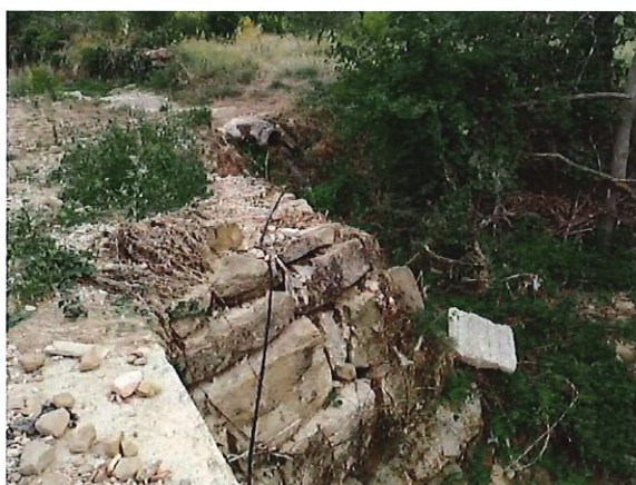
CAMINO 26 – Estribo deteriorado por la fuerza del agua de escorrentía.
