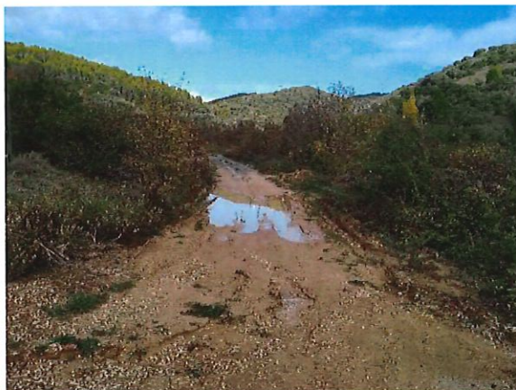
CAMINO 28 – Rodadas marcadas, baches, acumulación de material de arrastre.
