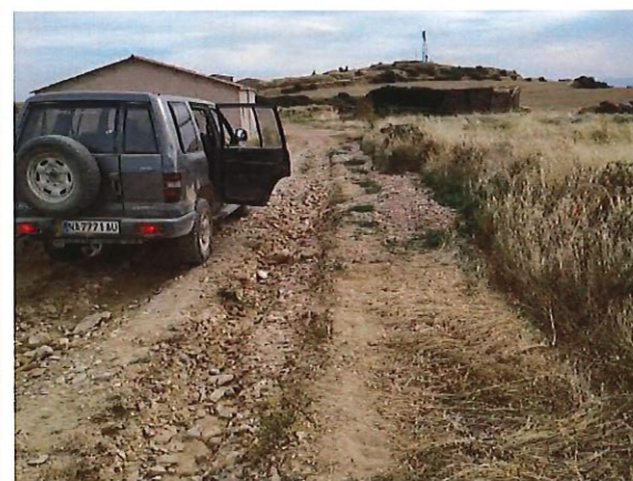
CAMINO 34 – Rodadas profundas en toda la longitud, circulación impracticable.
