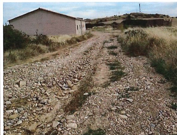
CAMINO 34 – Erosión, materiales sueltos, superficie irregular.
