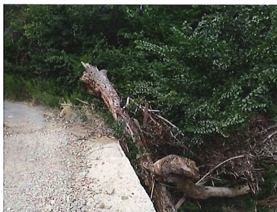
CAMINO 26 – Acumulación de vegetación arrastrada en el paso del agua.
