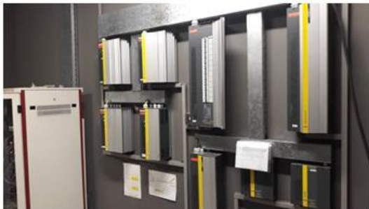
Sala de Control de iluminación (3)
