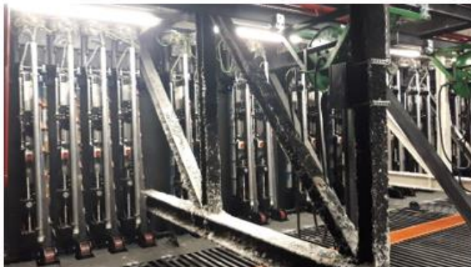
Conjunto de motorización de varas
