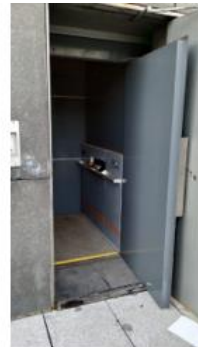
Cabina de plataforma + puerta acceso
