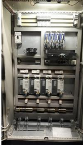
Variadores de velocidad varas motorizados
