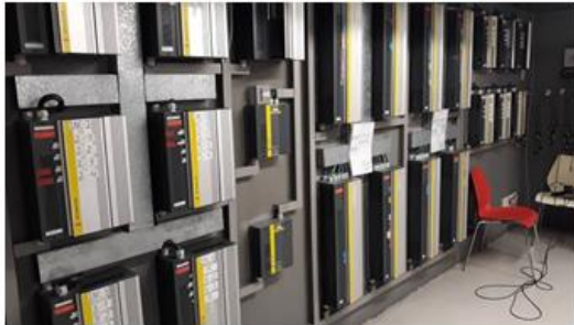
Sala de Control de iluminación (1)
