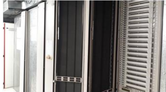
Sala de Control de iluminación (2)
