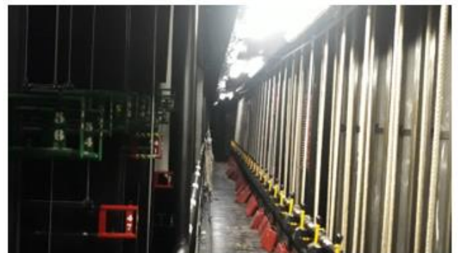
Conjunto de varas contrapesadas
