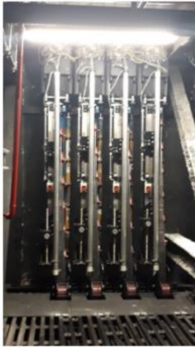
Motorización de varas
