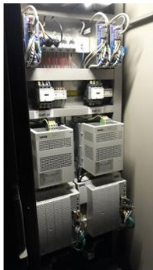
Armario de fuerza + control de 2 varas
