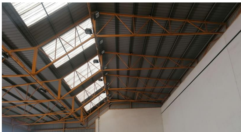
Disposición actual de focos - proyectores
