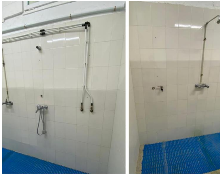
Estado actual de las duchas.
