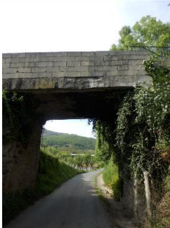
Pasos elevados en mal estado en el Tramo 1. Fotografías tomadas el 10-05-2024
