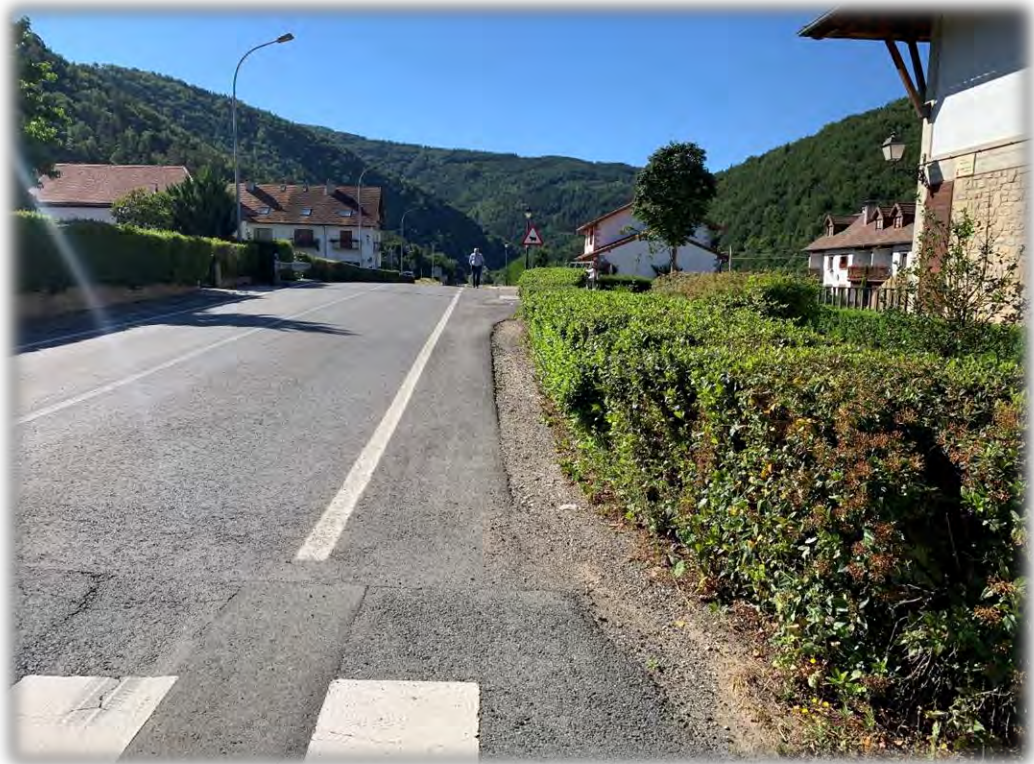
Fotografía 4: Al fondo acera si continuidad, acceso a la casa del Valle sin acera. La acera de la izquierda de la fotografía carece continuidad en ambos extremos, además de tener un pavimento en mal estado.
