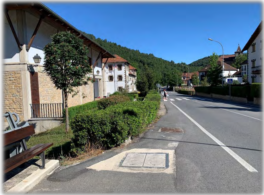
Fotografía 3: Acceso a la casa del Valle sin acera. La acera de la derecha de la fotografía carece continuidad en ambos extremos, además de tener un pavimento en mal estado.
