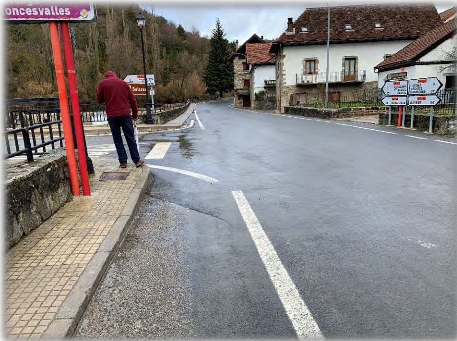
Fotografía 7: Acera no accesible, de menos de 1 m, a la entrada de la NA-140 al centro del pueblo. Y espacio de arcén suficiente para ampliar la acera.
