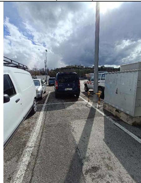
6-Armario de contadores y protección de las luminarias situadas entre plazas de estacionamiento.
