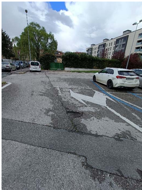
5-Vista de patologías del firme bituminoso zona 1
