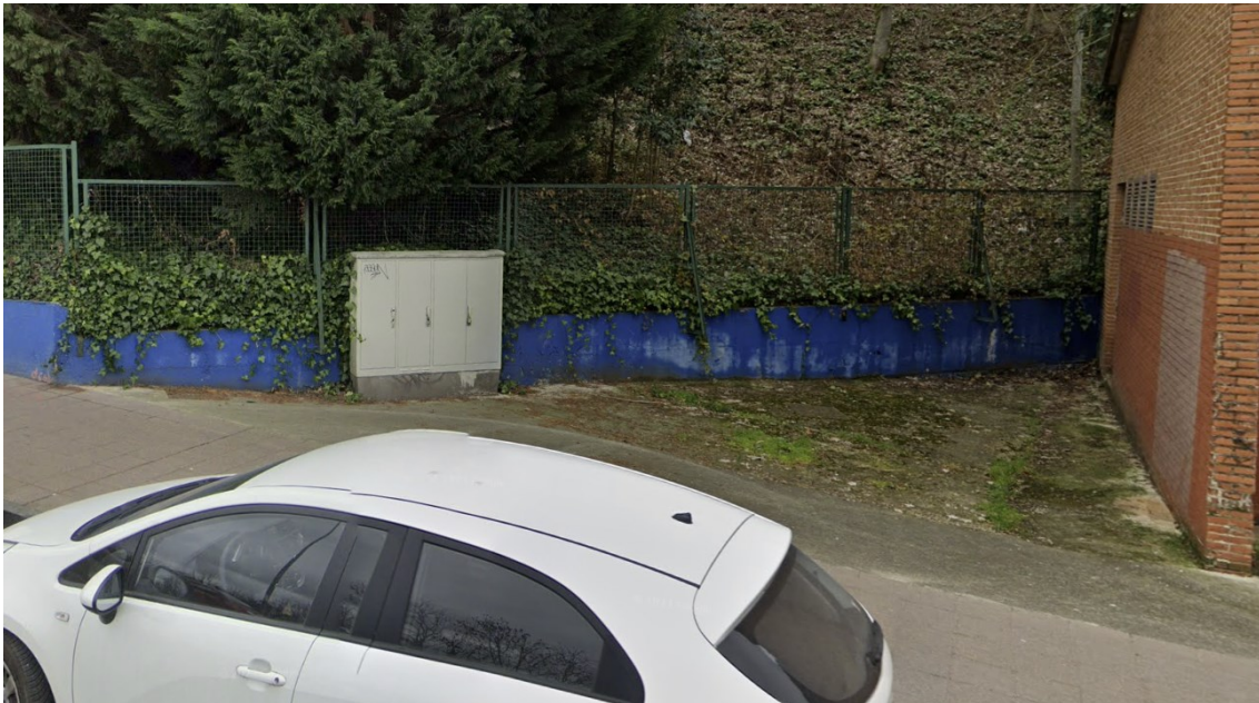
Imagen de la situación del cuadro de alumbrado.
