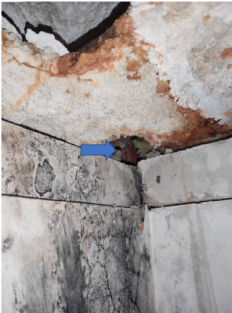
f.5 desde interior de cámara de falso techo (se observa el LCV desde el falso techo desmontable del aula y la tabiquería de cartón yeso con manchas derivadas de la entrada de agua)
