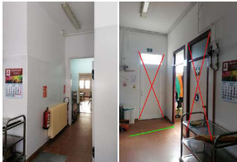
Foto izquierda: Pasillo de conexión cocina – comedor – zona de colocación de puerta RF E12-60. Foto derecha: Puertas a anular en cocina y puerta de evacuación definitiva a través de vestíbulo previo
