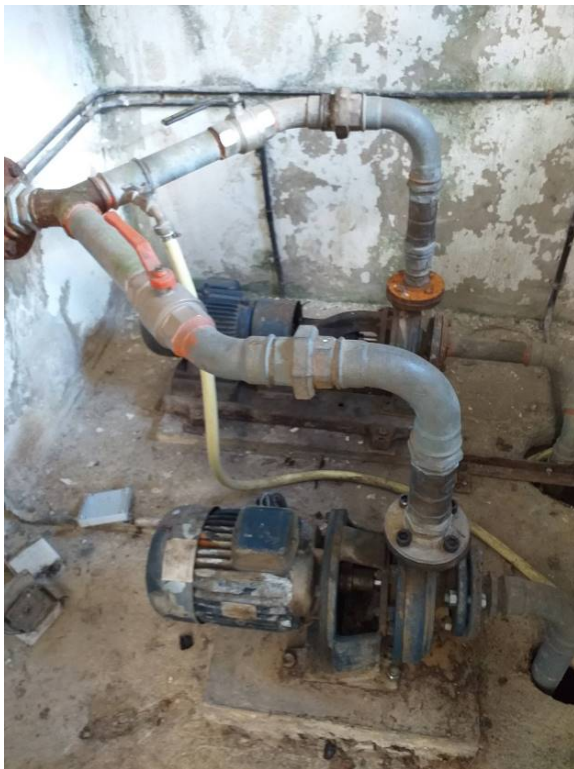
Figura 1: Estación de bombeo
