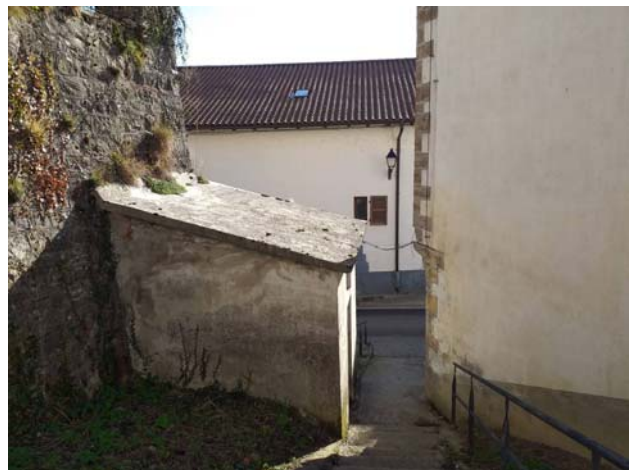
Figura 2: Caseta de bombas
