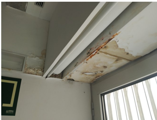
Foto 9: Entrada agua fachada sur lactantes
