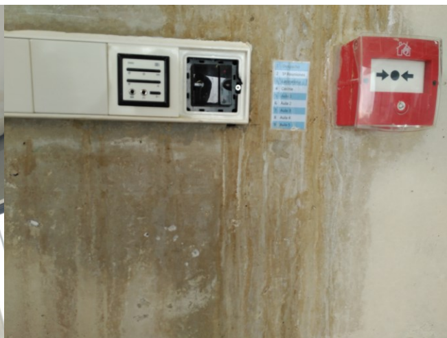
Foto 10: Entrada agua muro módulo
