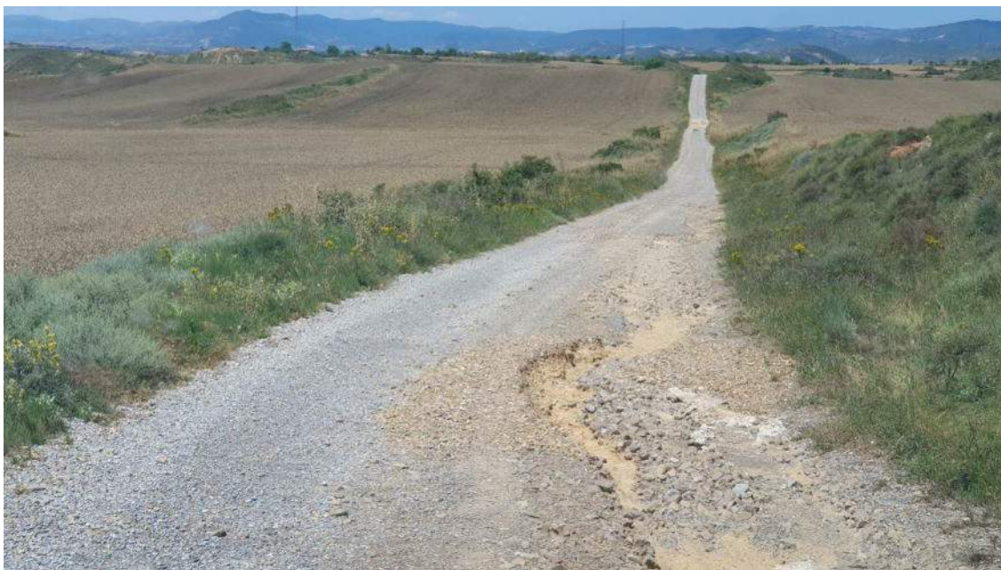
Camino Mosquerabaja. Daños graves en la capa de rodadura. Junio de 2023
