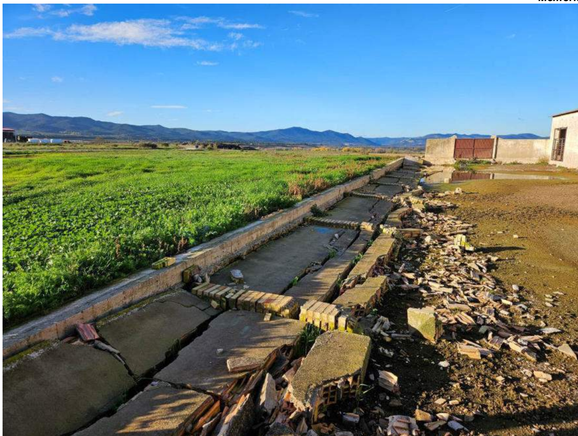
Otra fotografía del muro derribado. Noviembre de 2023
