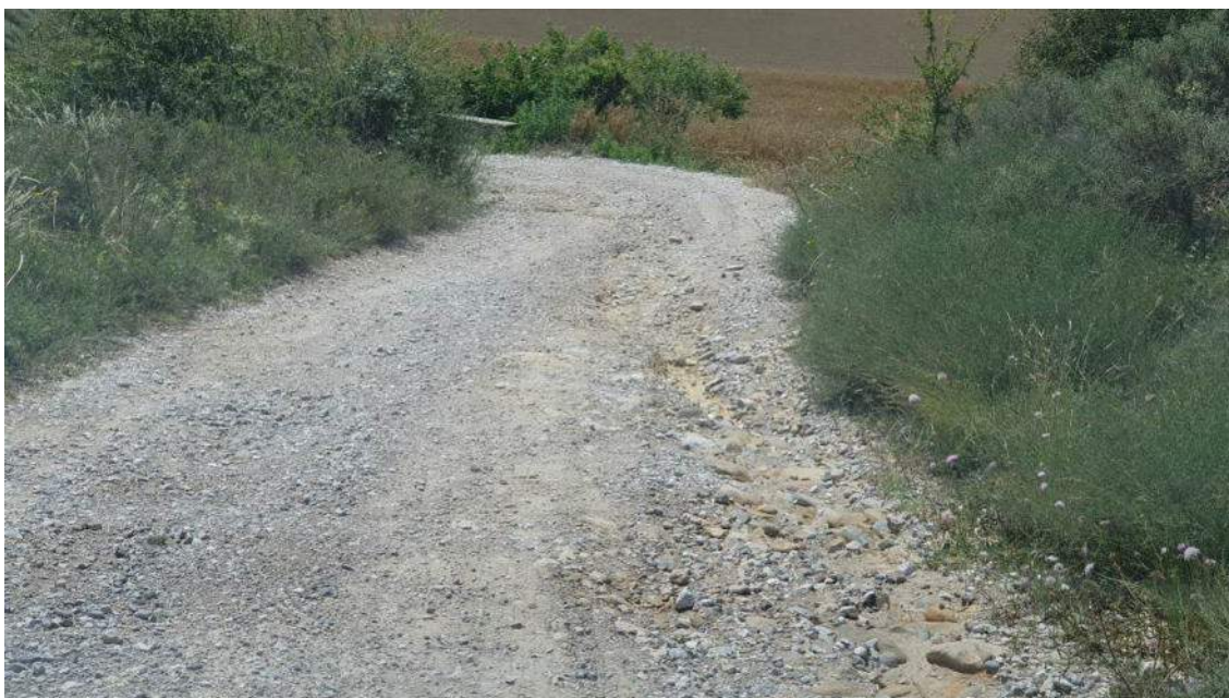
Camino donde la riada ha erosionado ligeramente la capa de rodadura
