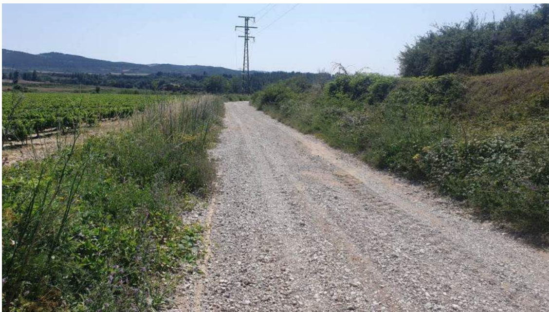
Camino donde la primera riada ha erosionado totalmente la capa de rodadura.
