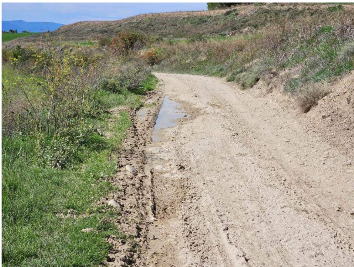
Camino Linas. Daños graves en la explanación. 26 de septiembre de 2023
