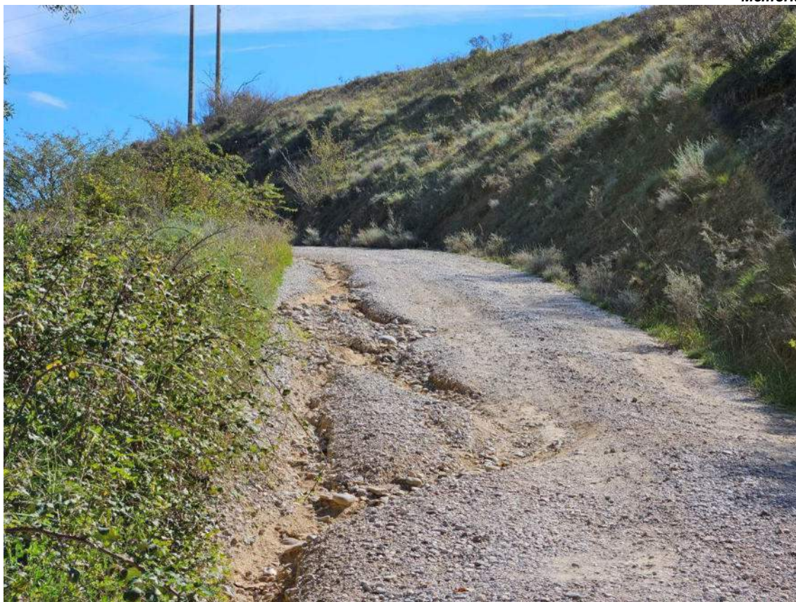
Camino Huertas Baratiñones. Daños graves en la capa de rodadura. 26 de septiembre de 2023
