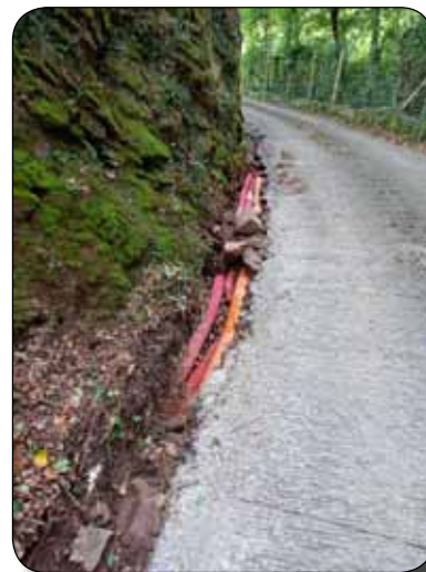
Peñaborda. Arrastres en la margen del pavimento y afloramiento de redes
