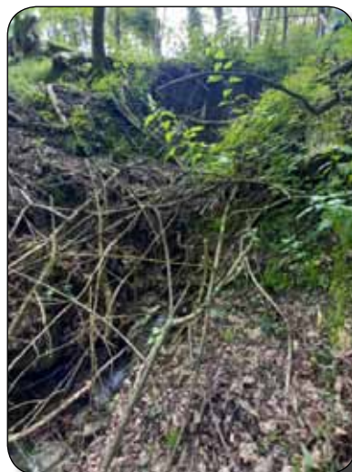
Suspelttiki 1. Restos de caños aguas abajo
