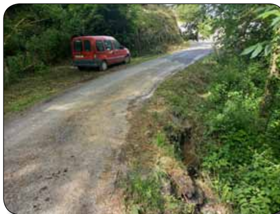
Suspelttiki 2. A la derecha se localiza el colapso
