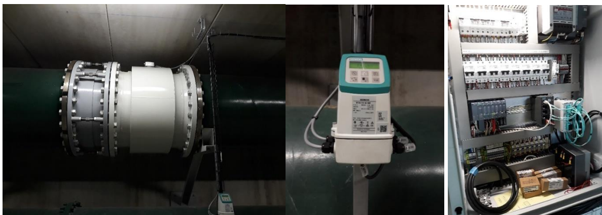
Foto caudalímetro existente instalado anteriormente y cuadro de control
