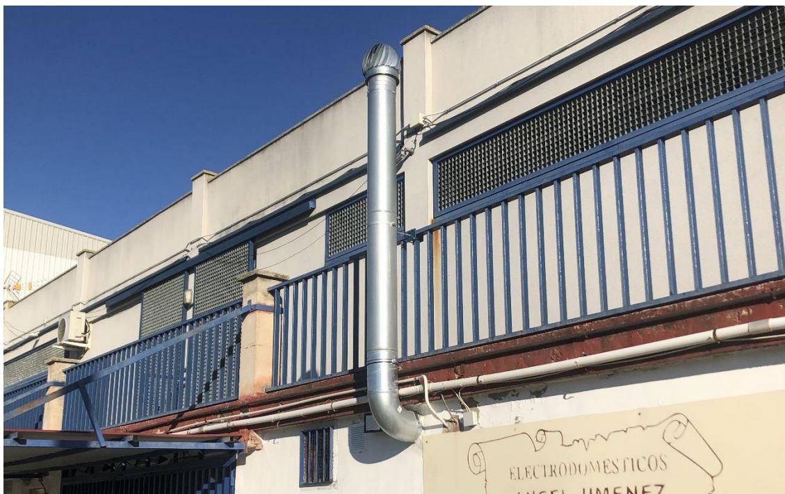
IMAGEN 12 y 13– Extracción de humos por fachada. Instalaciones sobre borde de forjado
