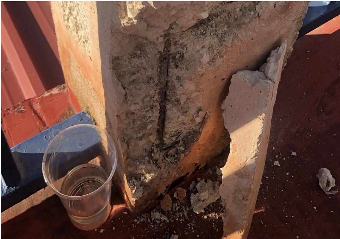
IMAGEN 06 – Carbonatación por humedad en pilares de la galería
