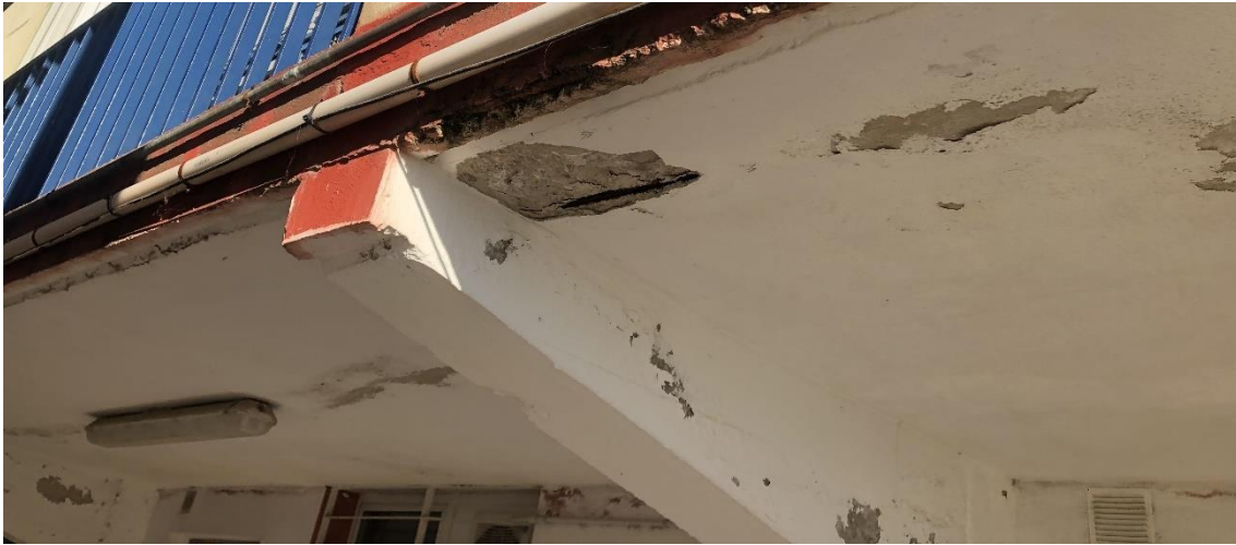
IMAGEN 05 – Carbonatación por condensación en galería exterior
