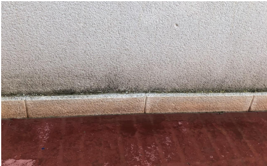
IMAGEN 08 – Humedades por capilaridad en encuentro Galería-Fachada
