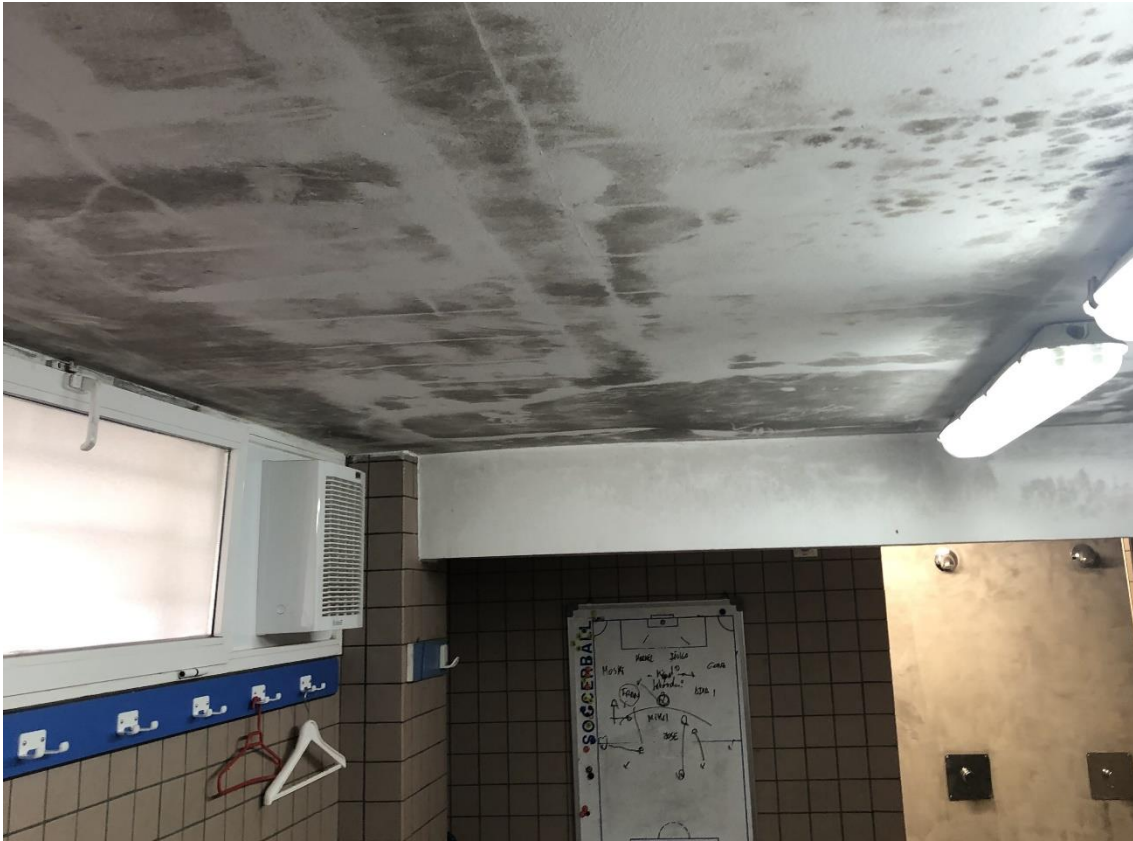
IMAGEN 03 – Humedades por condensación en Vestuarios
