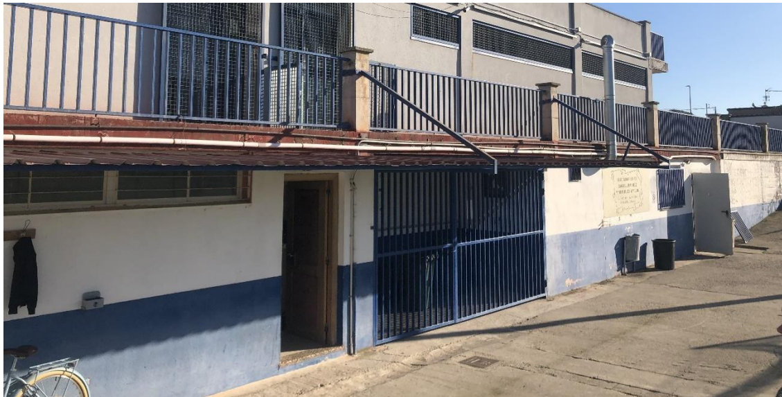
IMAGEN 11 – Marquesina – Voladizo apoyado sobre pilar fisurado y con carbonatación avanzada.
