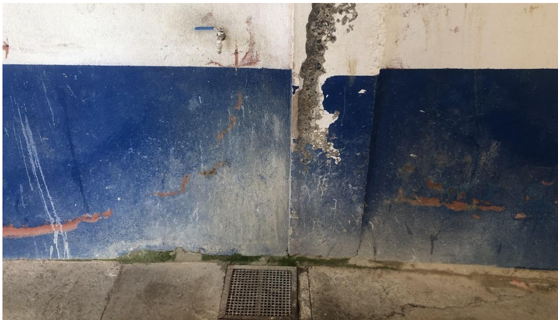
IMAGEN 07 – Humedades por capilaridad en estructura (Pórtico inferior)
