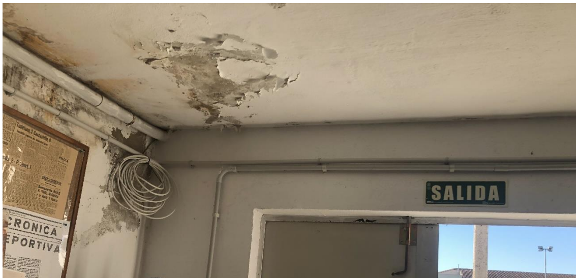
IMAGEN 04 – Humedades por condensación en Oficina-Almacén
