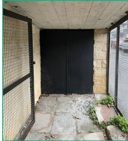
11. Imagen. CPM cerrado, lugar donde se propone ubicar los inversores y el contador de generación
