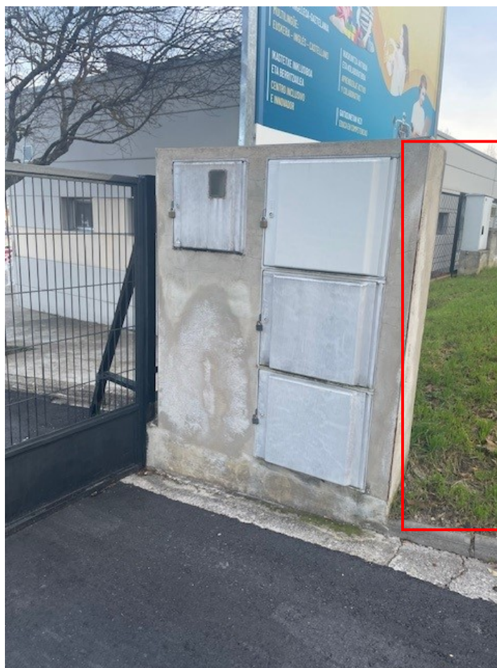
Ilustración 17. Lugar de colocación del armario eléctrico homologado por I-DE
